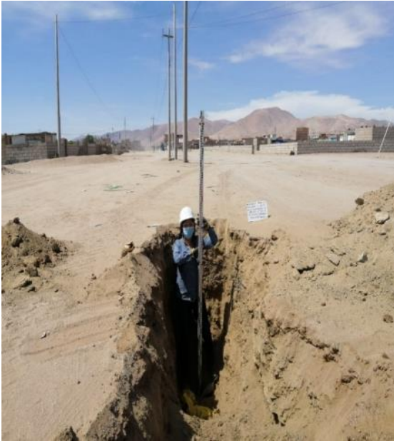
IMAGEN N°1: Se observa los estratos, altura y muestra del suelo de la excavación de la calicata 01
