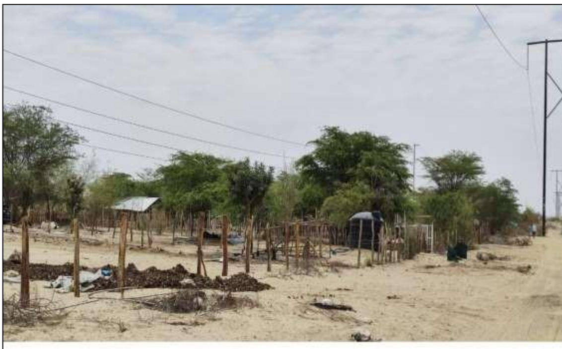
Tanques de almacenamiento ubicados en puntos centrales para la distribución a las viviendas
