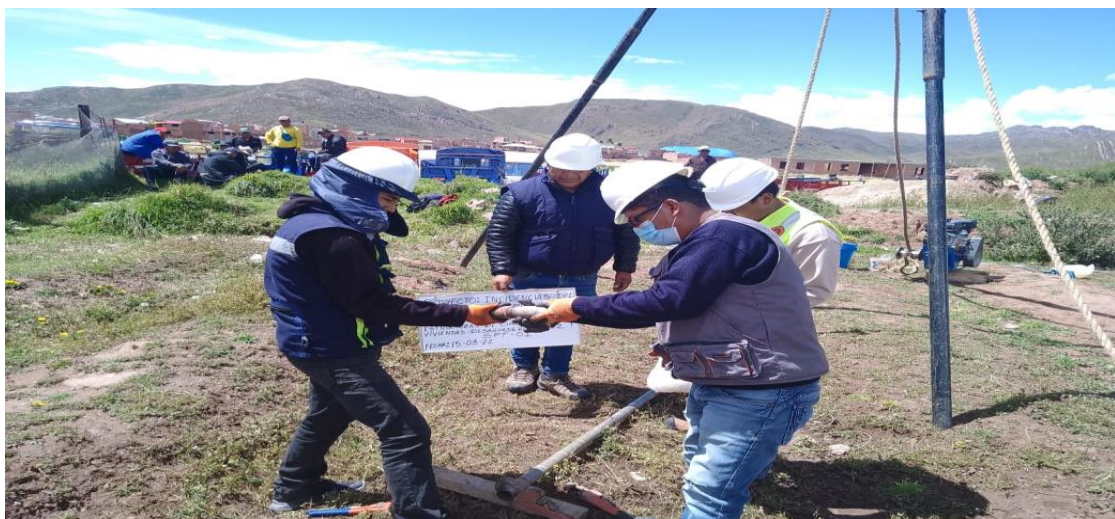
Figura 4.5. Extrayendo el tipo de suelo utilizando la prueba de penetración estándar STP. Fuente: elaborado por tos tesistas.
