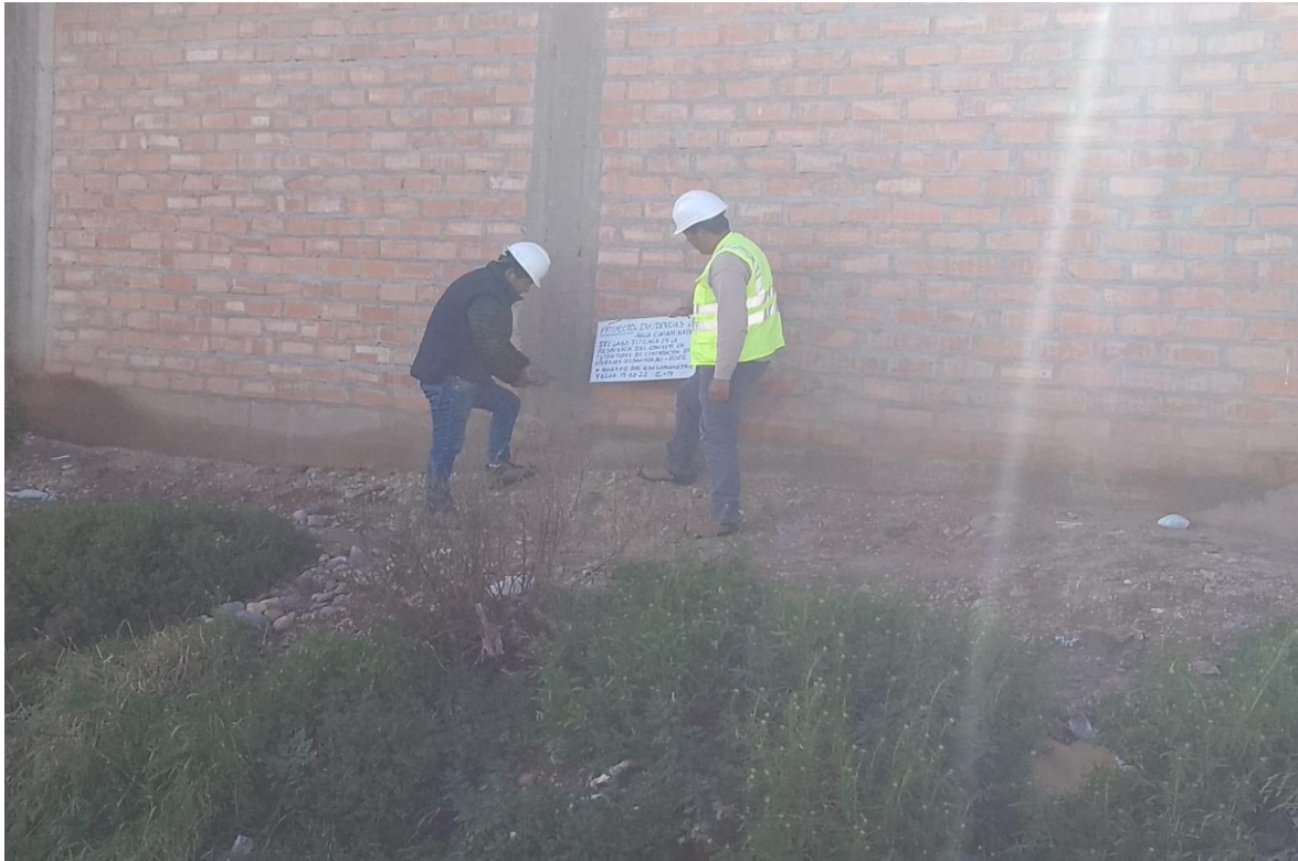
Fotografía 10 Ensayo de Esclerómetro en columnas en contacto con agua en viviendas de desaguadero.
