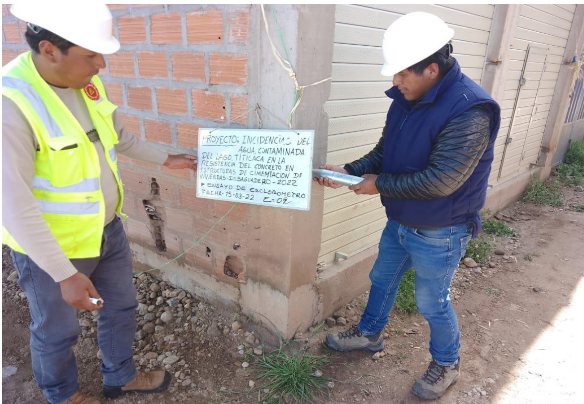
Fotografía 09 Ensayo de Esclerómetro en contacto con agua en columnas.
