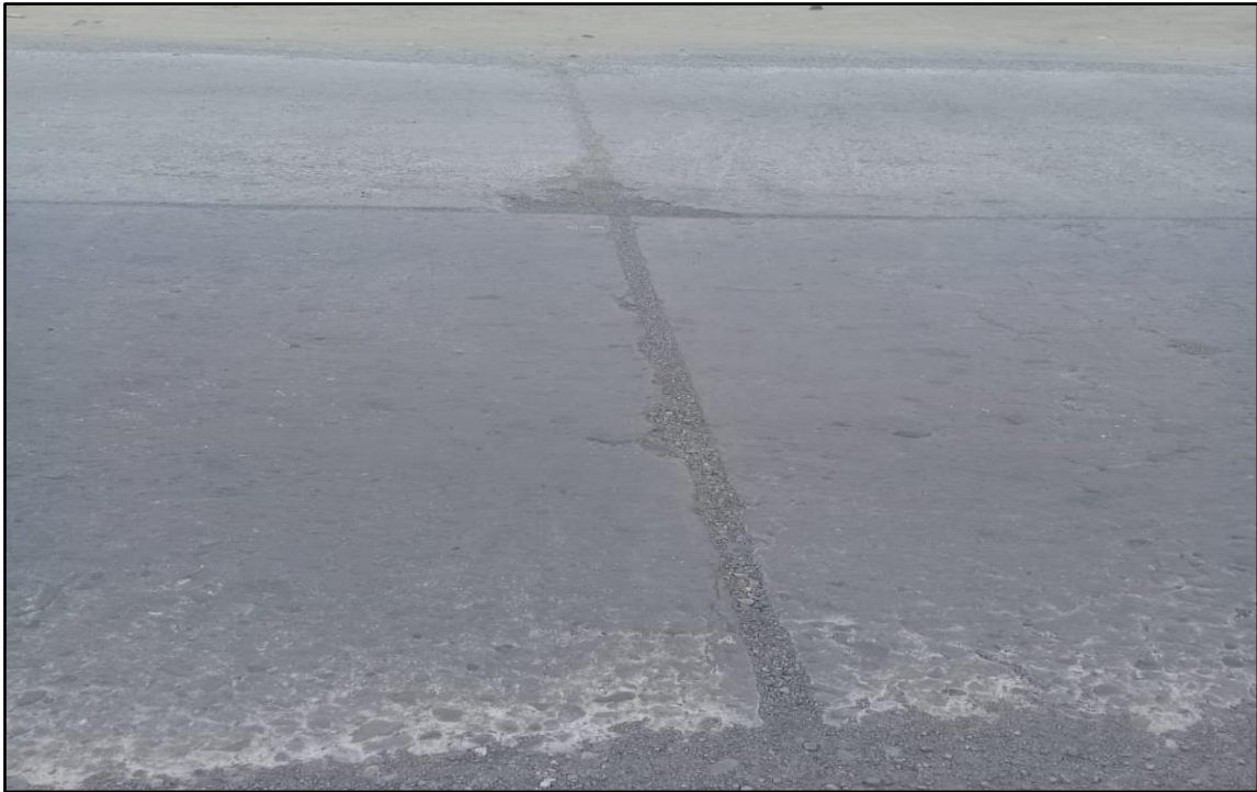
Reconocimiento falla Grieta de reflexión de junta
