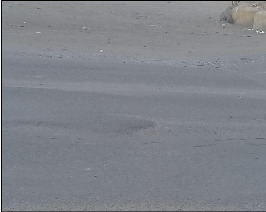
Reconocimiento de falla, Hinchamiento
