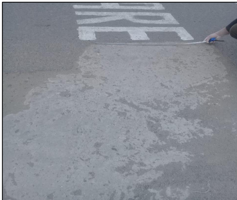
Reconocimiento de falla, Parcheo, severidad media
