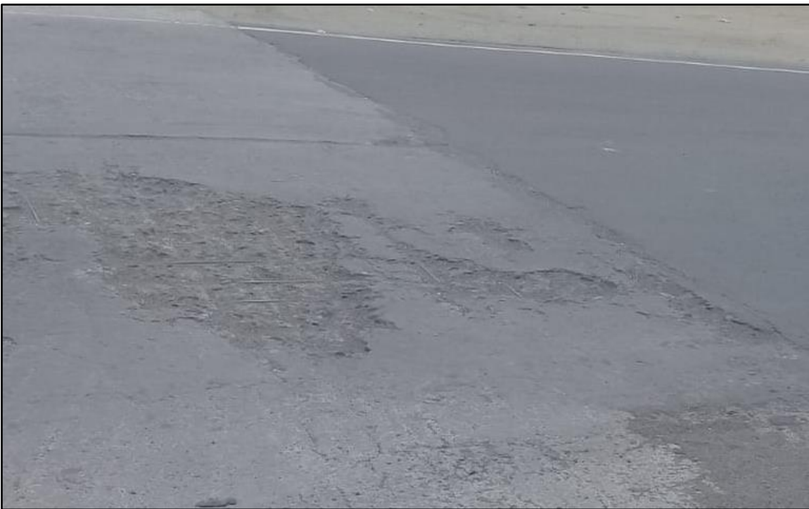
Reconocimiento de falla, Parcheo con nivel de severidad muy deteriorado
