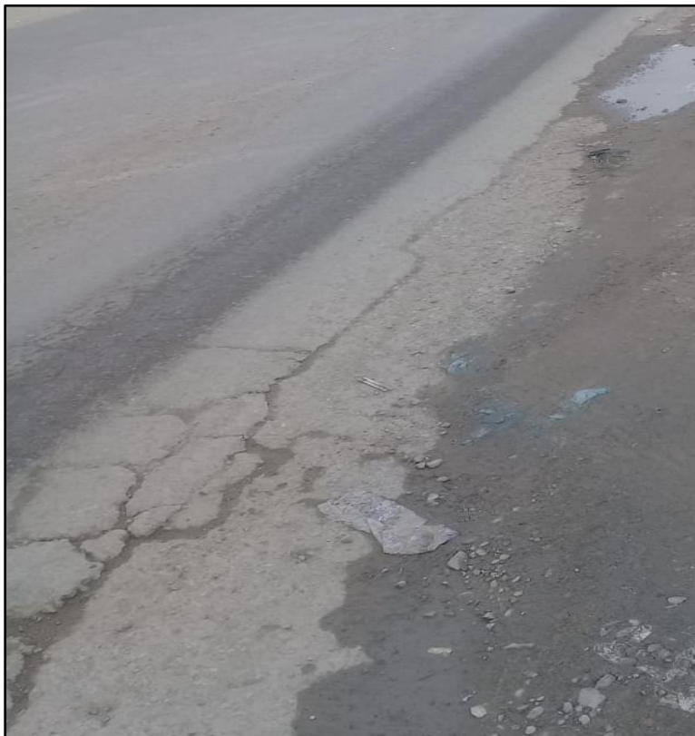
Reconocimiento de falla, Exudación, Grieta de borde, Agrietamiento en bloque severidad leve.
