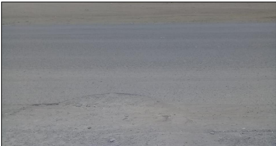
Reconocimiento de falla, Grieta de borde con desprendimiento a lo largo del borde
