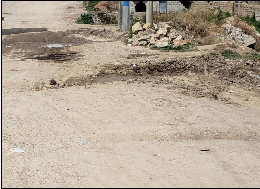
Figura 5: Ahuellamiento en la cuadra 5 Jr. Ica. Fuente: Elaboración propia.
