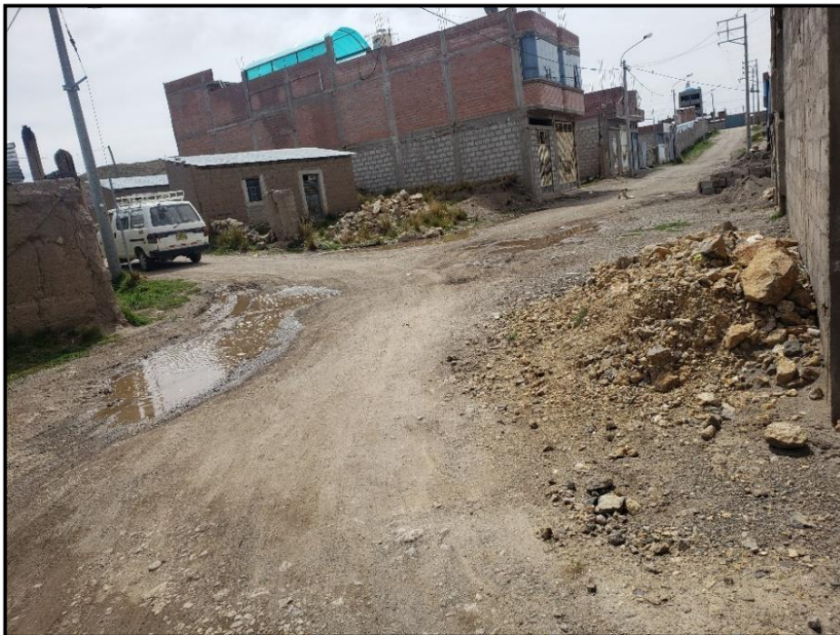
Figura 6: Presencia de baches en la cuadra 6 Jr. Ica. Fuente: Elaboración propia.
