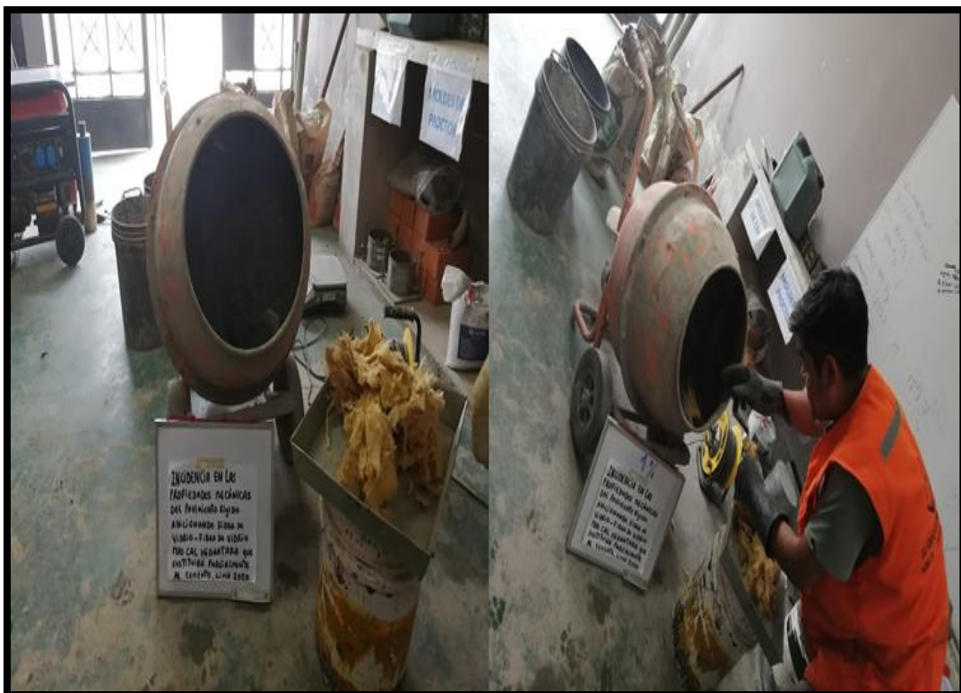
Figura 48. Proceso mezclado de materiales y adición de la fibra de vidrio y cal hidratada.
