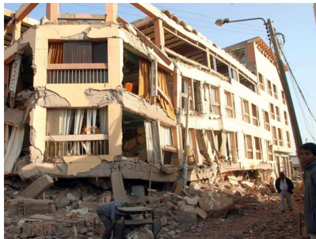
Figura 2 Daños - Terremoto 2007- Ica
