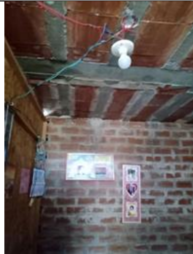
Figura 43 Dormitorio 03 – Se puede observar la losa aligerada – Deficiencias en las instalaciones
