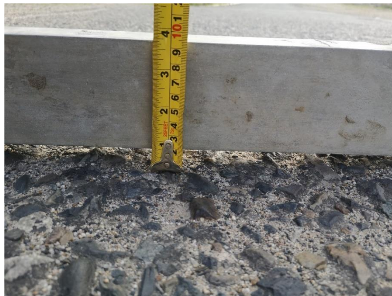
Figura 4: Toma de medidas del daño ubicado.
