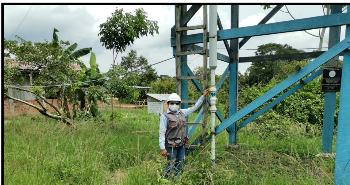
Se aprecia en la toma fotográfica el sistema de abastecimiento del Caserío Santa Rosa. – línea de aducción.
