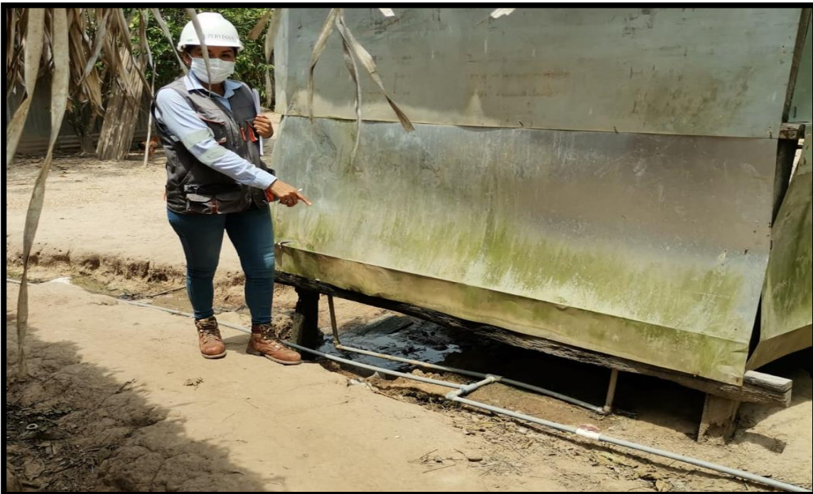
Se aprecia las redes domiciliarias en mal estado de una de las viviendas del caserío Santa rosa
