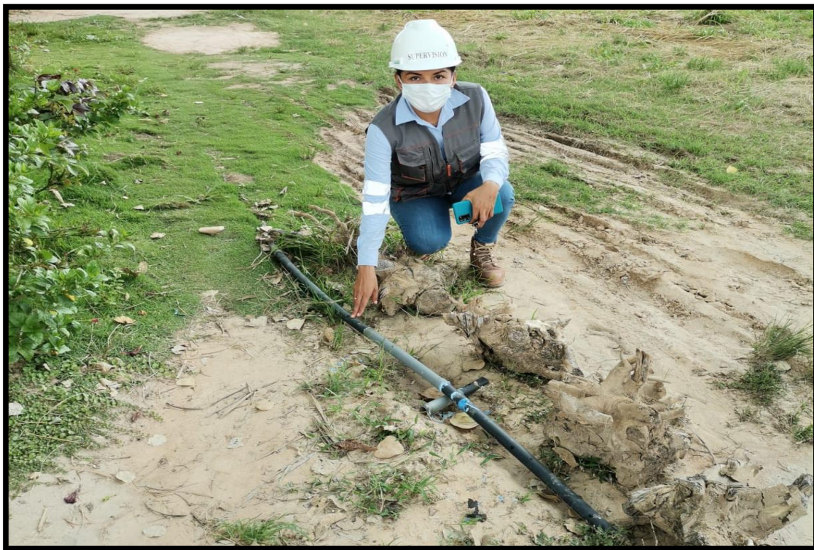
Se aprecia las redes de distribución primaria – se encuentran en mal estado.
