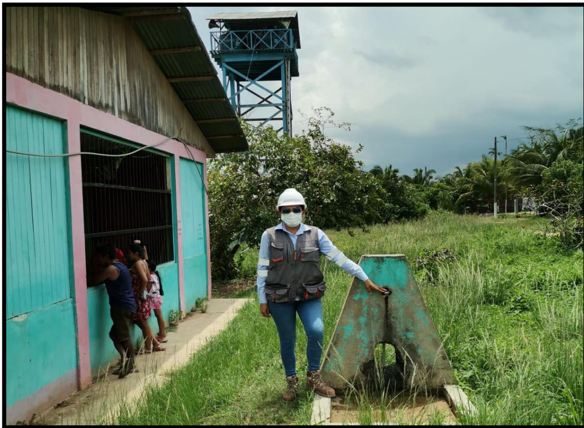
Se aprecia una pileta publica en mal estado – al costado del local comunal
