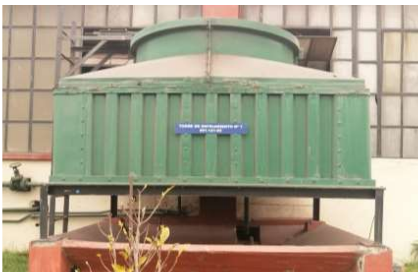
Figura 20. Torre de Enfriamiento de sala N°1
