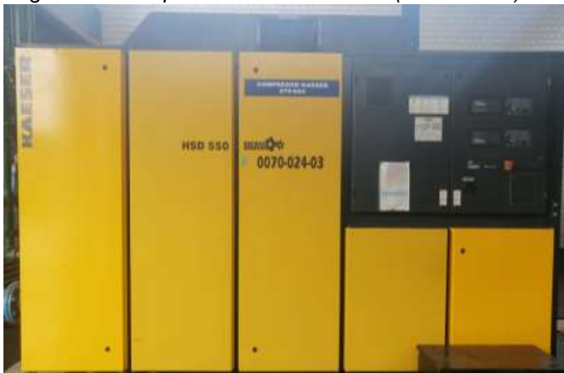
Figura 17. Compresor Kaeser 070-024 (vista frontal)
