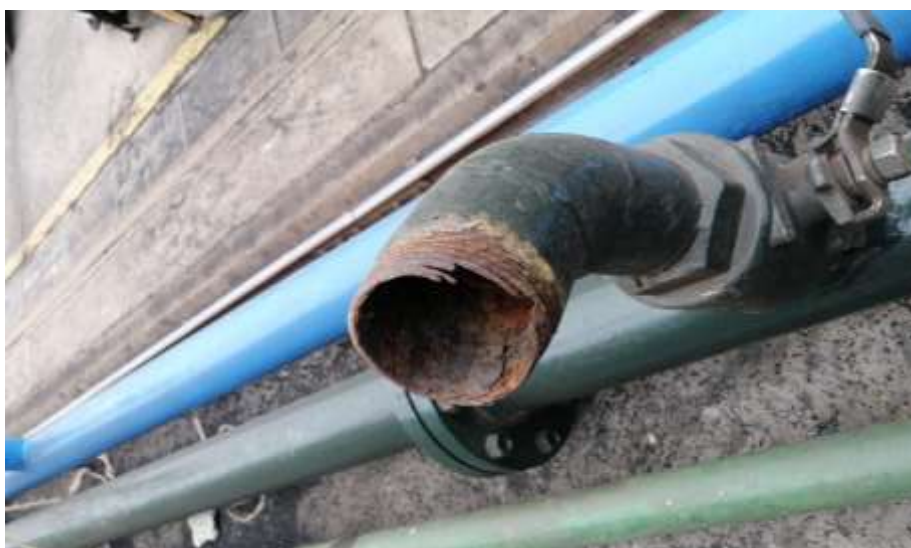
Figura 21. Válvulas seccionadoras rotas de aire comprimido
