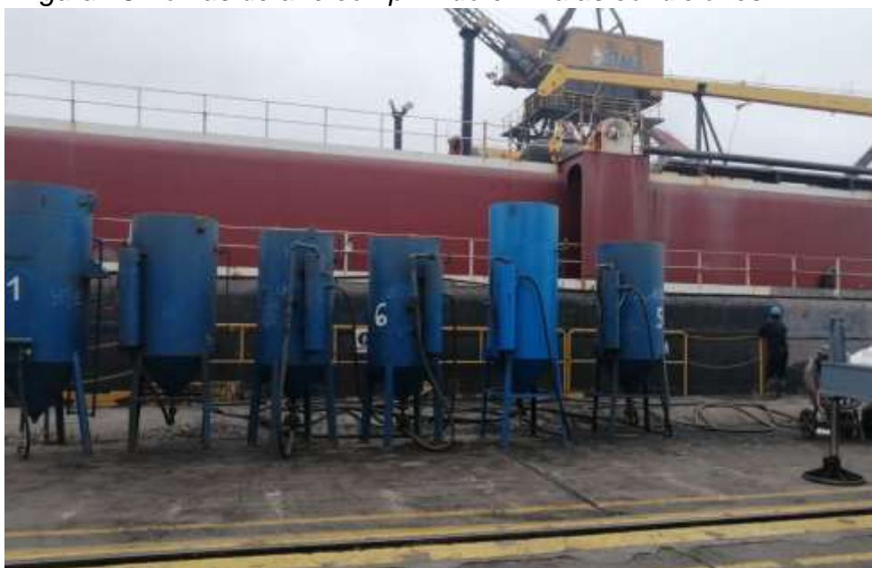
Figura 28. Tomas de aire comprimido en malas condiciones
