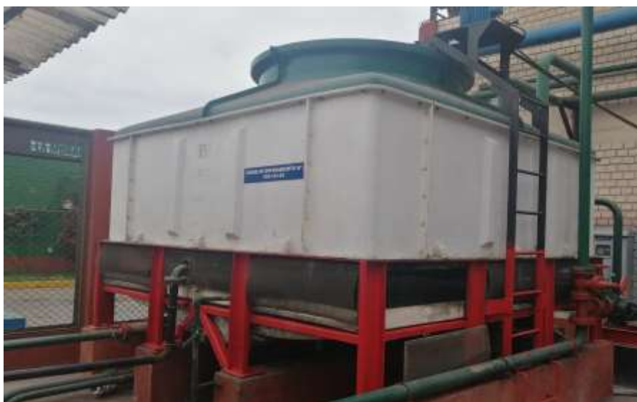
Figura 19. Torre de Enfriamiento de sala N°2
