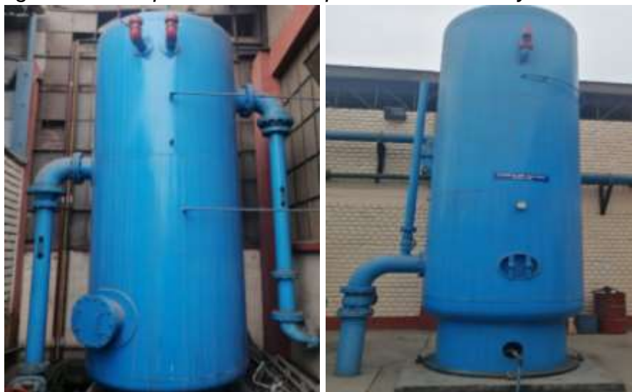
Figura 26. Tanques de aire Comprimido - Sala N°1 y N°3
