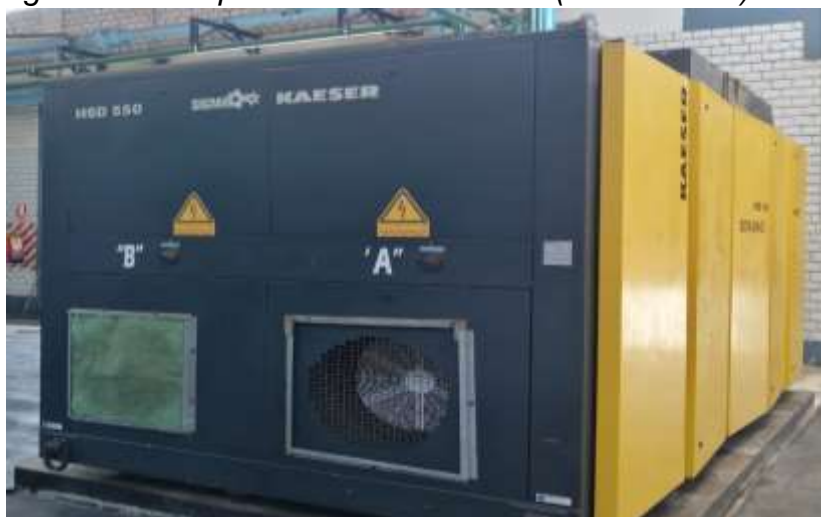
Figura 18. Compresor Kaeser 070-024 (vista trasera)
