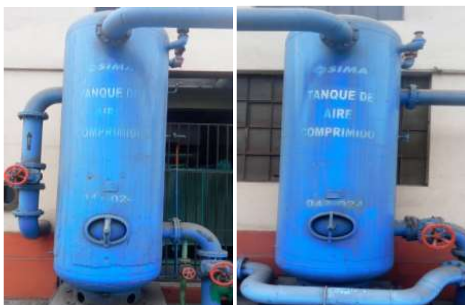
Figura 27. Tanque de aire comprimido - Sala N°2
