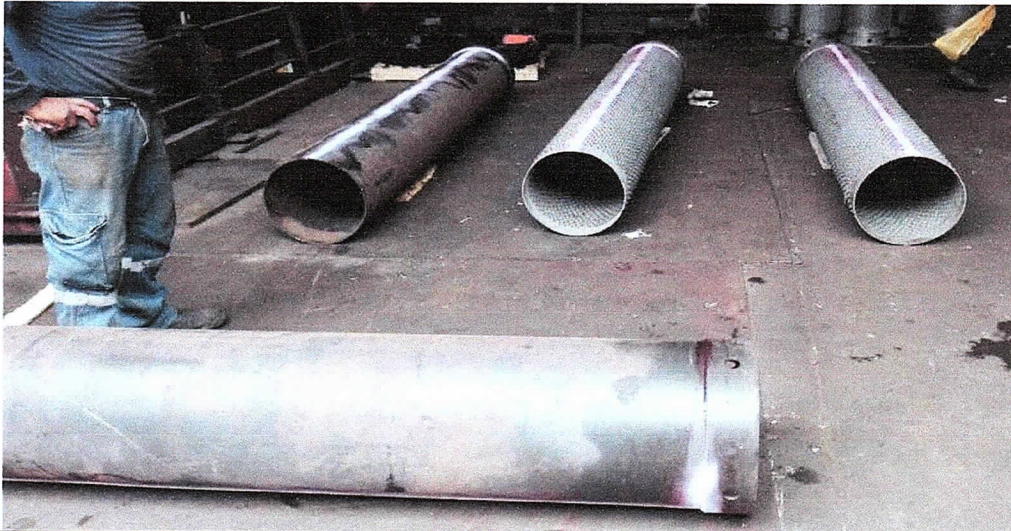
Se observa los dos filtros y tuberías ciegas que pasaron por la prueba
