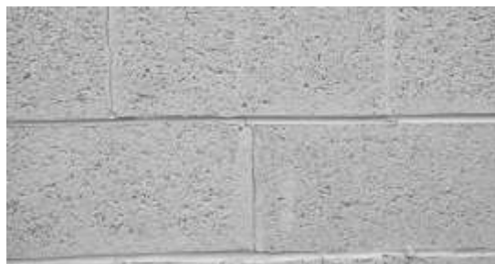
Figura 2: Fisuras en los muros
