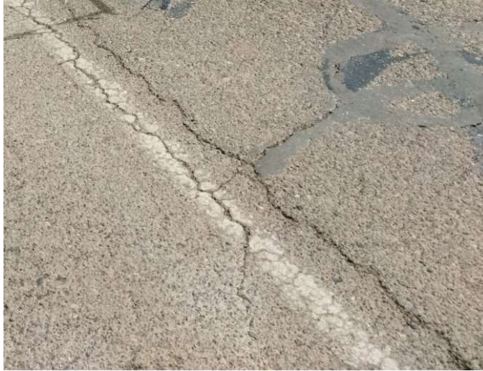
Figura 19: Daño tipo grietas longitudinales y transversal
