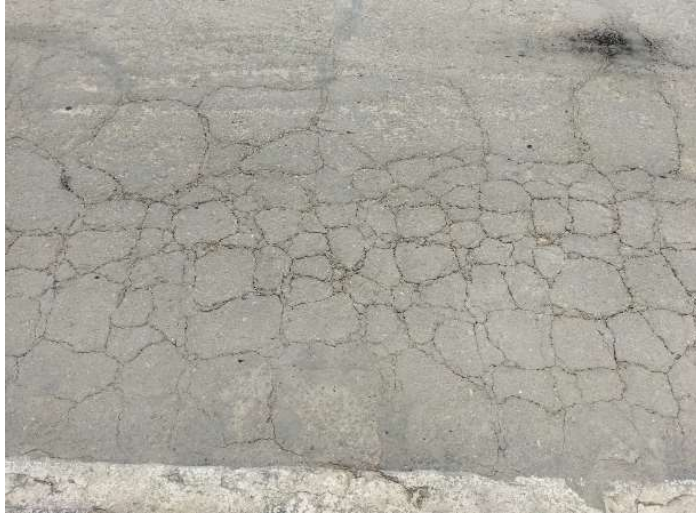
Figura 17: Daño tipo Piel de cocodrilo
