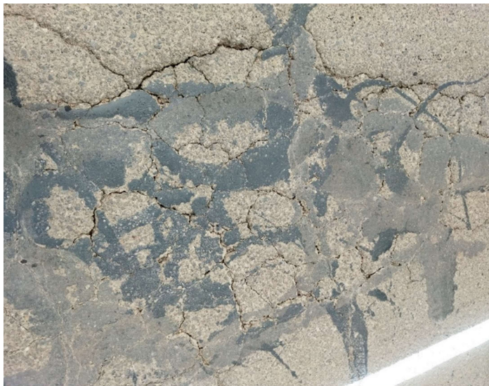
Figura 18: Daño tipo agrietamiento en bloque
