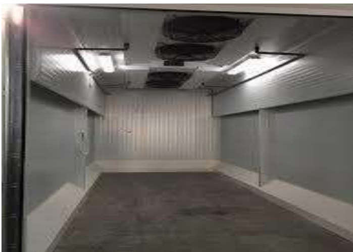
Figura 21: Túnel de frío
