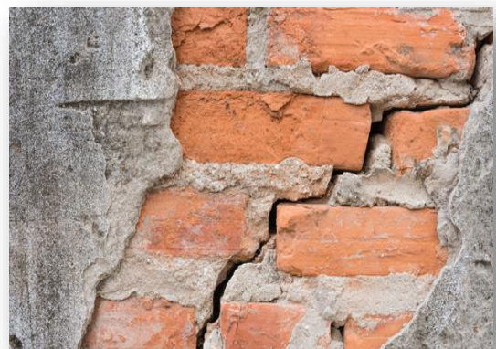
Figura 1. 1 Asentamiento de ladrillos y unidades de ladrillo de baja calidad
