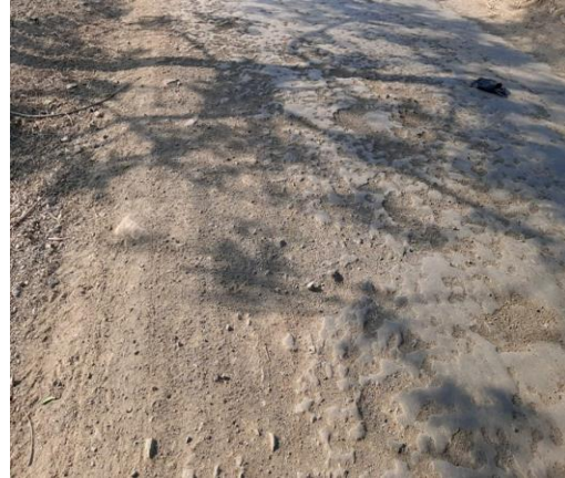
Figura 02: Desgaste de la plataforma.
