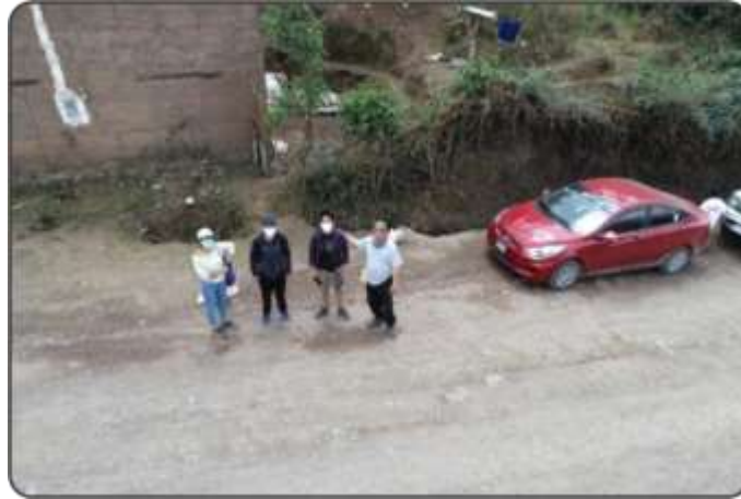
Figura 22. Punto de partida para dar inicio el proceso de excavación de las calicatas. Fuente: Elaboración propia.
