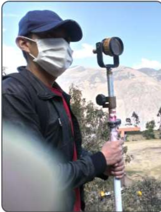
Figura 20. Cogiendo el prisma, para que el topógrafo tome el punto con estación total, en la carretera Abancay - Huayllabamba.
