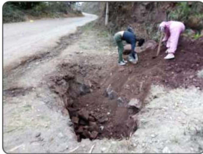
Figura 35. Rellenando el hueco de la calicata C-3, para dejarlo como en su estado original.
