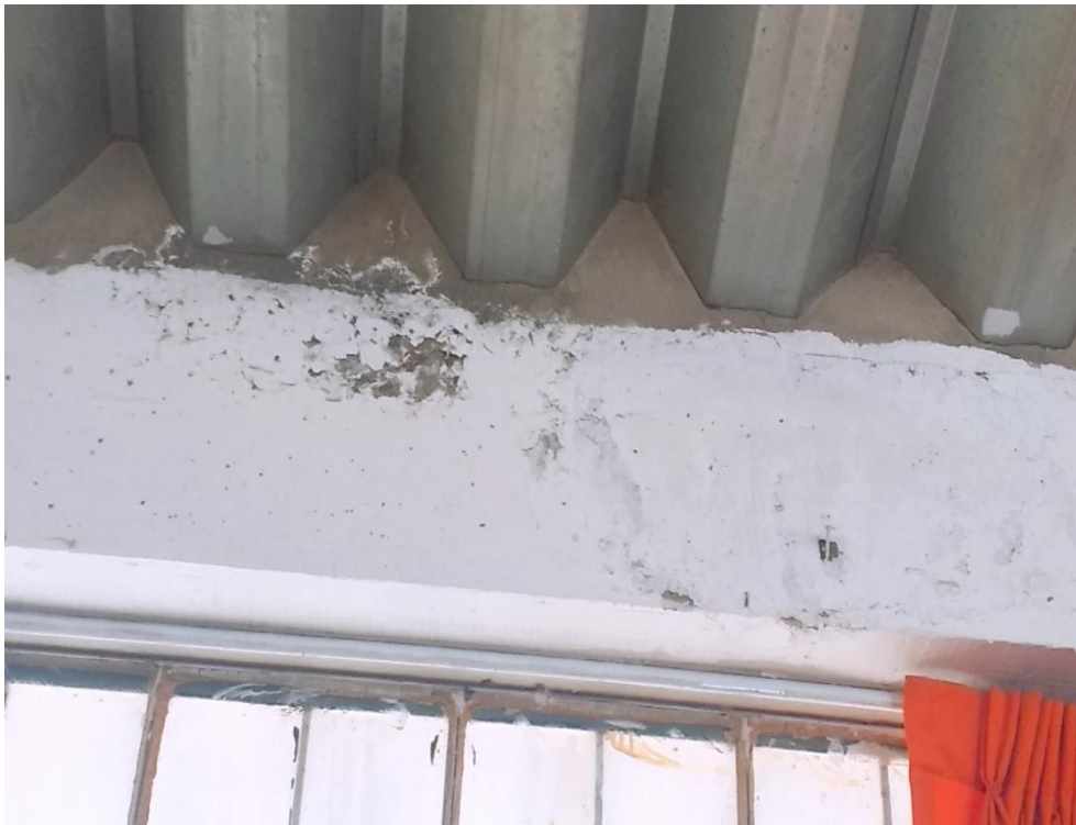
Presencia de fisuras y grietas en vigas
