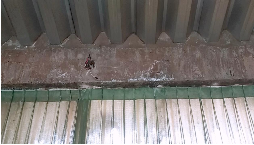
Presencia de eflorescencia en vigas
