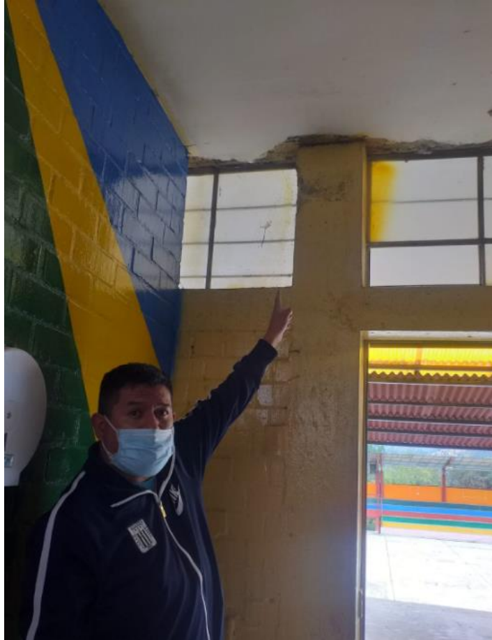
Presencia de erosión y corrosión en viga
