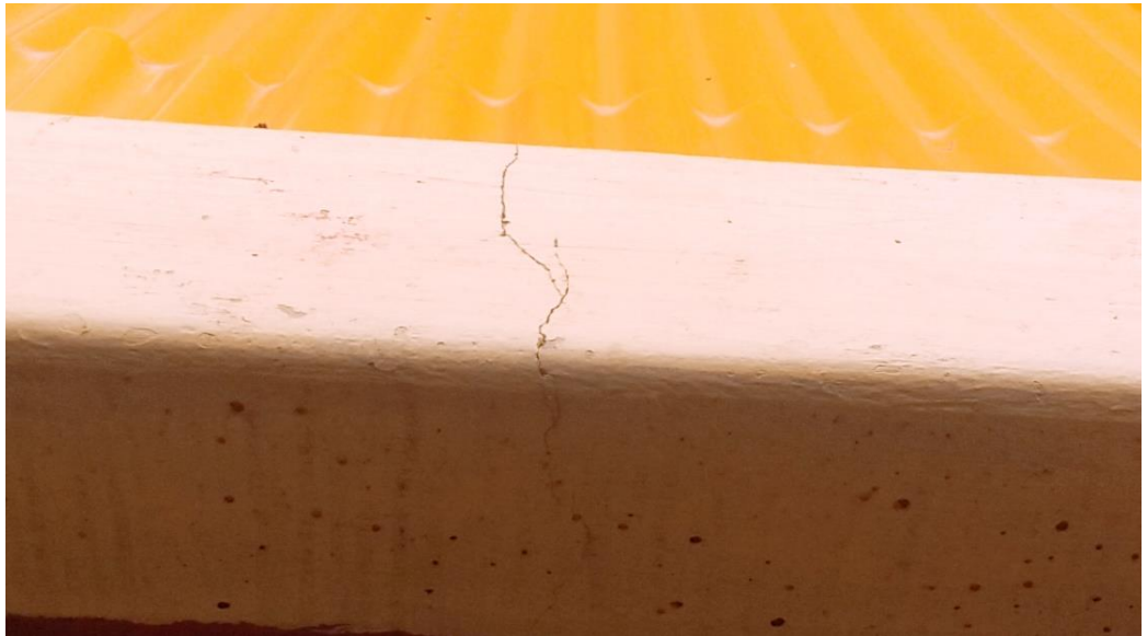
Presencia de grietas en viga
