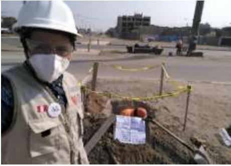
Anexo 24. Se llego a la meta con las dimensiones adecuadas para la excavación requerida en base a la norma.
