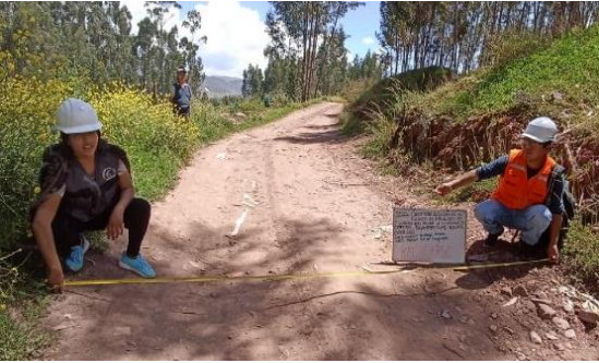
Foto 04. Estado actual de la via Raqayraqayniyoc - Huacoto (Km 6+300).
