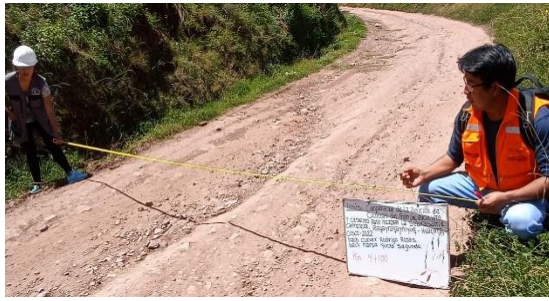
Foto 03. Estado actual de la via Raqayraqayniyoc - Huacoto (Km 3+650).
