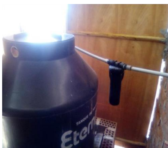
Tanque dosificador de cloro (600 lt) – Estación Nº 02
