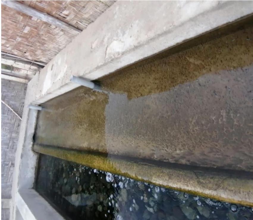
Fotografía N° 03 – Ingreso a la prefiltro de grava del sector 1 al 2.
