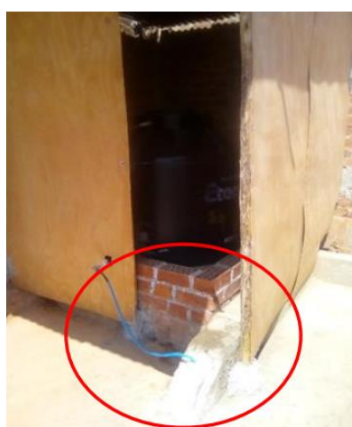
Ingreso al reservorio por manguera de ¼", caseta de triplay de protección
