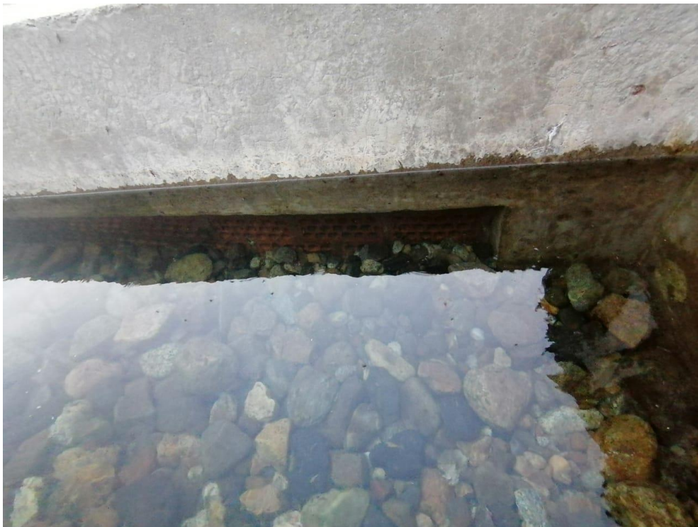
Fotografía N° 06 – Malla metálica que sirve como soporte para las capas del prefiltro, esta oxidada debido a la antigüedad.
