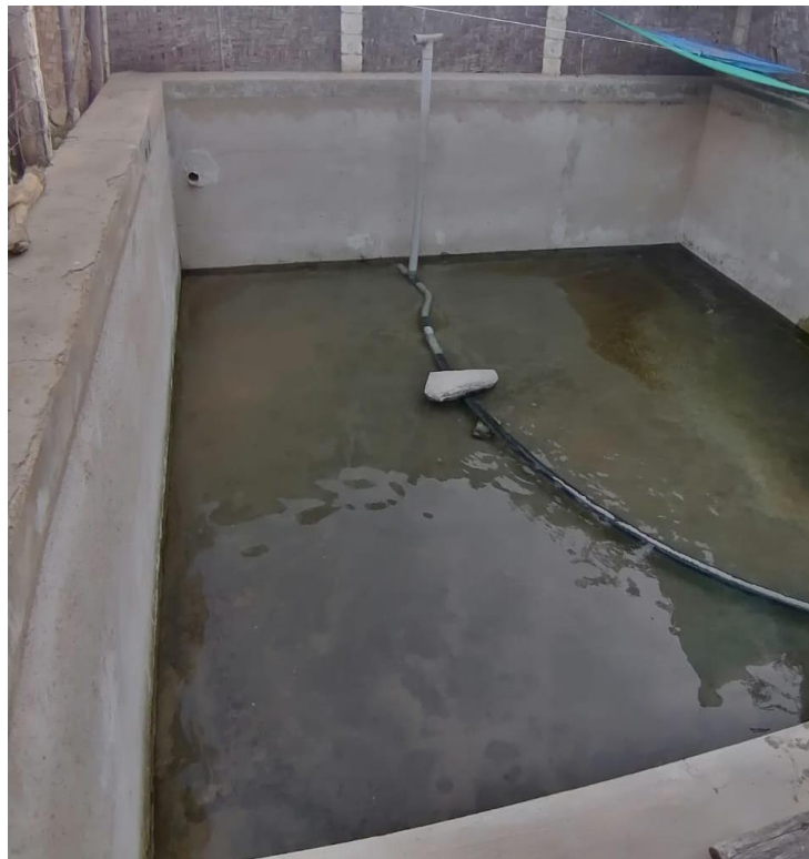
Fotografía N° 08 – Sedimentador en buen estado con una tubería improvisada.
