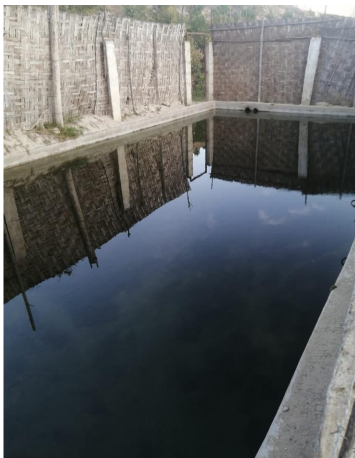
Fotografía N° 02 – Presedimentador, ingreso a la PTAP (Sector 1) sin espacio para inspección y cerco perimétrico improvisado.
