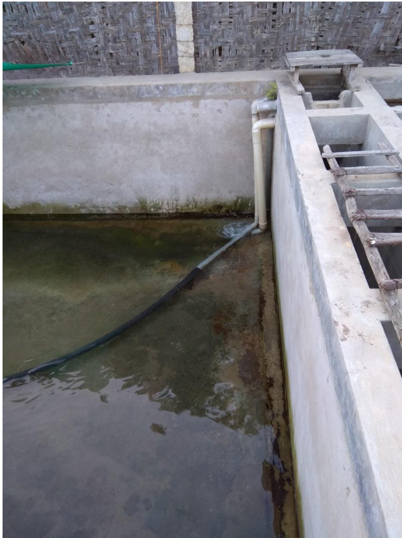
Fotografía N° 14 – Ingreso al sedimentador, las tuberías no tienen una disposición adecuada.
