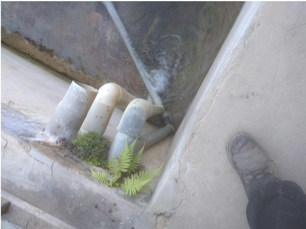
Fotografía N° 12 – Ingreso al sedimentador en malas condiciones y con vegetación.
