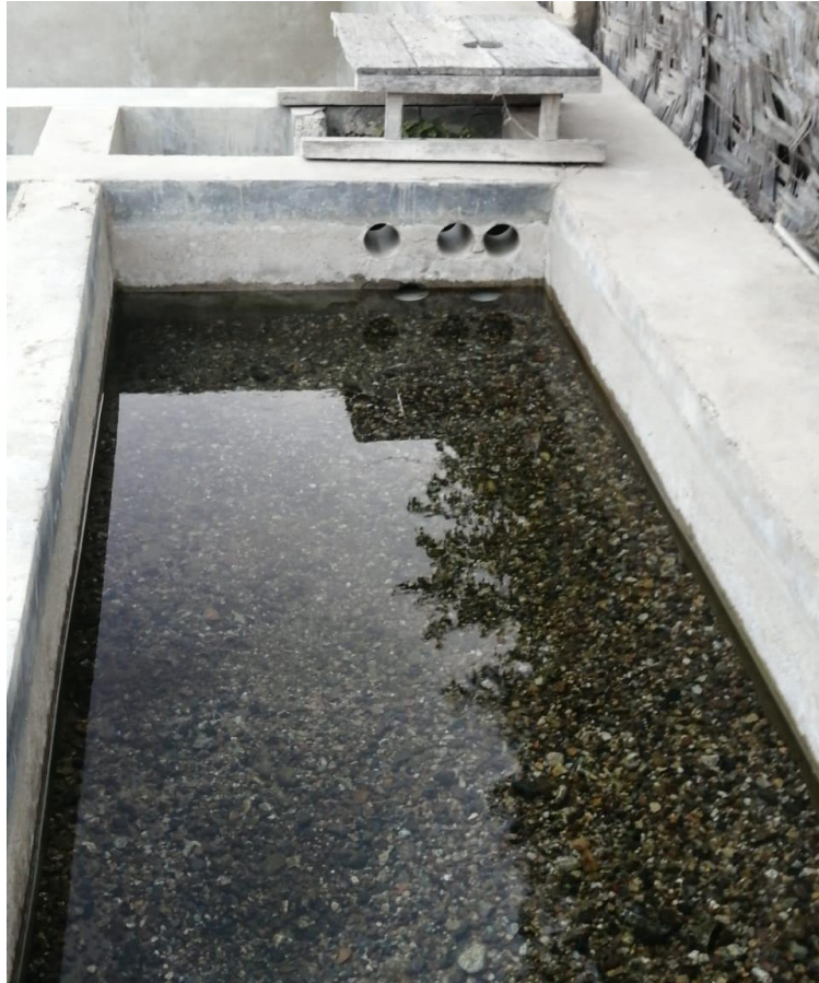
Fotografía N° 07 – Conexión del prefiltro de grava con el sedimentador, al no alcanzar nivel se improviso con una tubería de 3”
