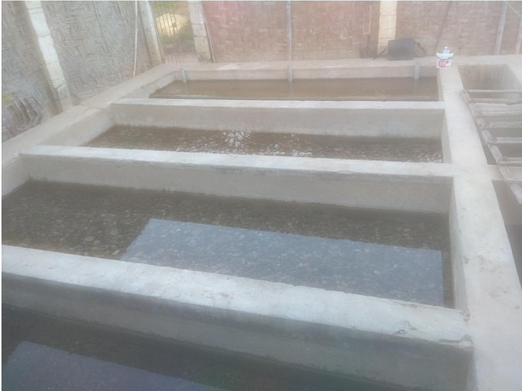
Fotografía N° 11 – Acceso al Área 02 de la PTAP
