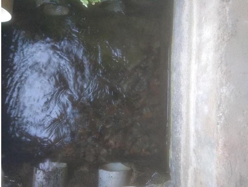
Fotografía N° 13 – Salida del prefiltro de grava
