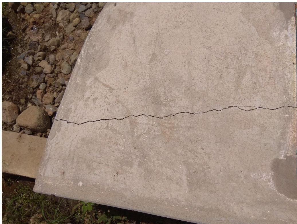
Fotografía N° 09 – Rajaduras en los muros del sedimentador
