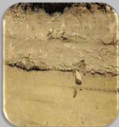
Foto 1. Estado de la carretera tramo Pinar - Marian
