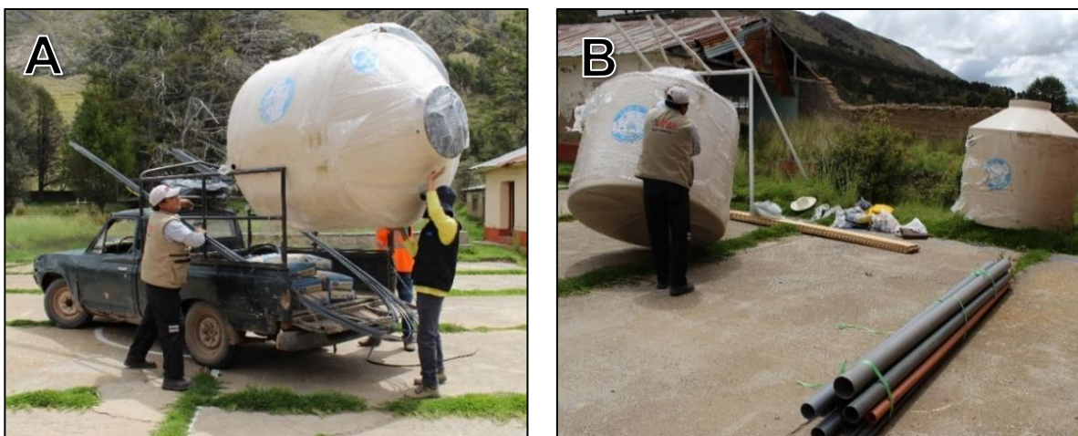
Figura 5: Materiales y equipos para el sistema de captación de agua pluvial
