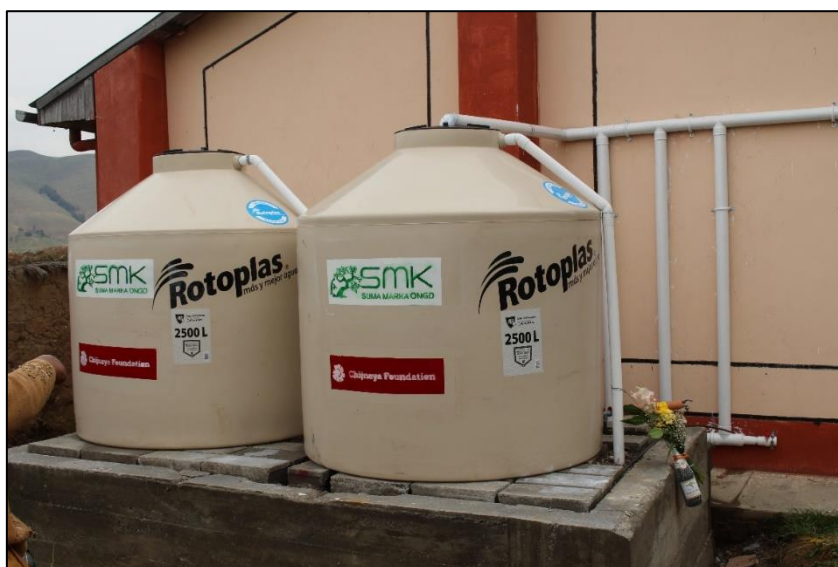
Figura 11: Sistema de captación de agua pluvial en la institución educativa N°70568.
