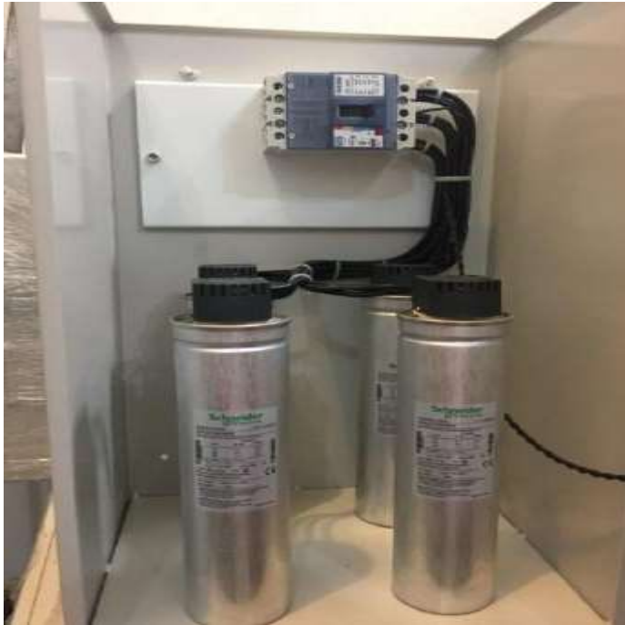
Figura 10: Banco de condensadores fijos.
