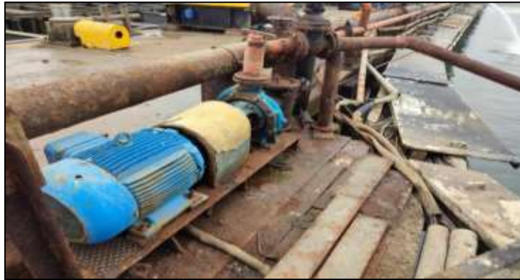
Figura 42: Electrobomba N°2 del Sistema de Dragado.
