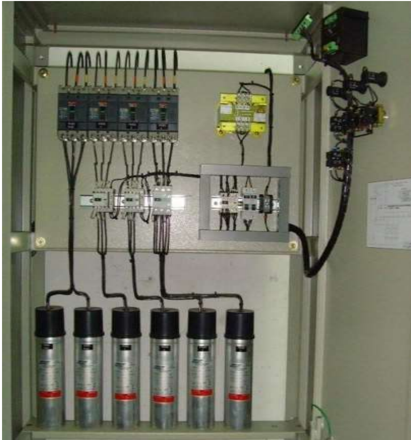
Figura 12: Banco de condensadores mixto.
