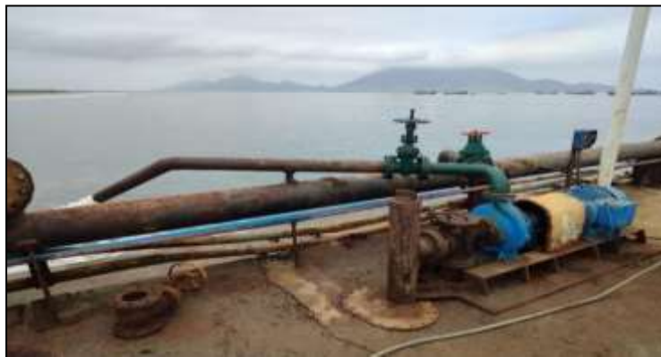
Figura 41: Electrobomba N°1 del Sistema de Dragado.
