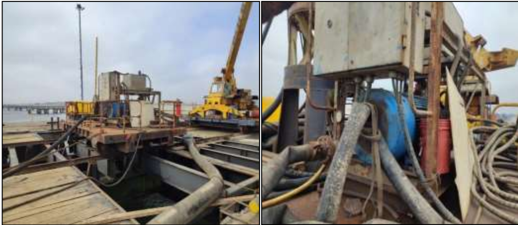
Figura 40: Bomba DOP del Sistema de Dragado de la plataforma Syncrolift.
