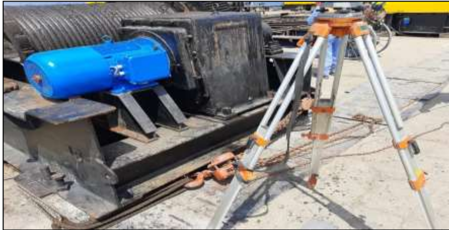
Figura 44: Winche de 135 Toneladas de la plataforma Syncrolift.
