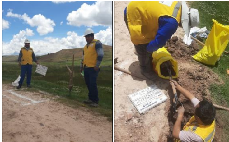
Figura 13. Las dos imágenes corresponden a la Calicata N°01, donde la imagen de la izquierda muestra el trazo donde se va a realizar la excavación y la imagen de la derecha muestra el proceso de la toma de muestra de la calicata.
