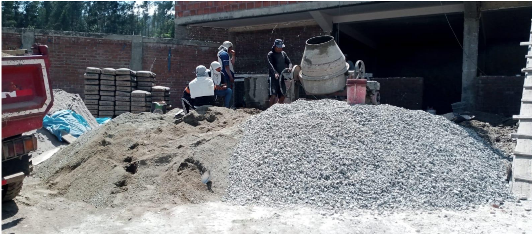
Figura 2 Almacenamiento de agregados en contacto con el suelo
