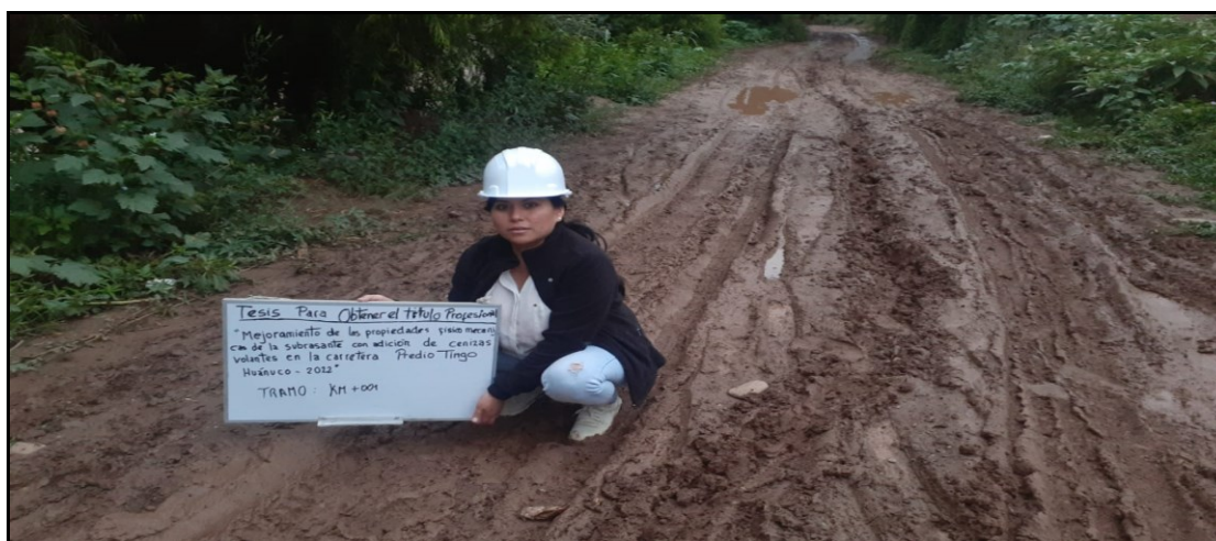
Deficiencias de carretera Predio Tingo Huánuco 2022. Km+001
