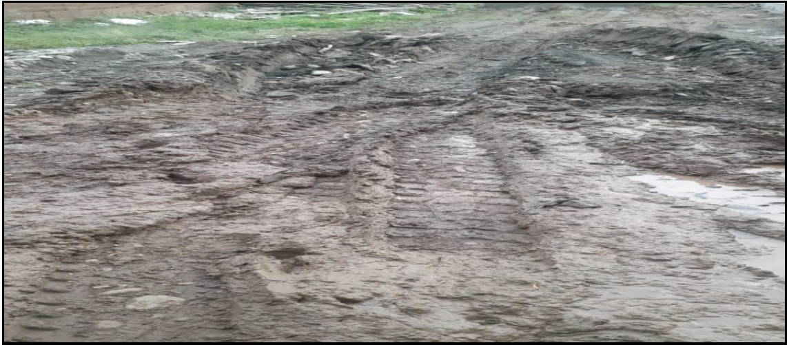
Hundimiento de carretera Predio Tingo-Huánuco Km+002, a causa del paso de un camión volquete
