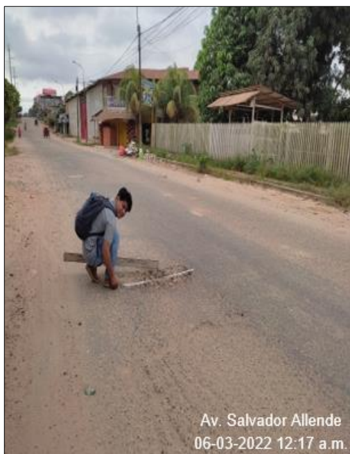
Fotografía 15. Tramo XVI Progresiva del 0+1490 al 0+1548 Se puede observar el deterioro tipo "B" bacheo y parcheo.
