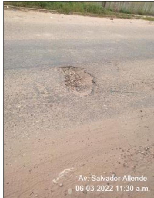
Fotografía 15. Tramo XV Progresiva del 0+1390 al 0+1490 Se puede observar el deterioro tipo "B" ojo de pescado.
