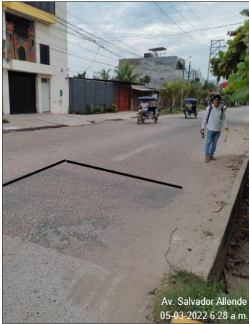
Fotografía 05. Tramo I Progresiva del 0+000 al 0+100 Se puede observar el deterioro tipo "A" parcheo y bacheo.
