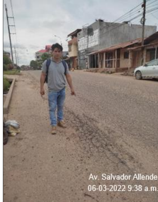
Fotografía 15. Tramo XII Progresiva del 0+1190 al 0+1290 Se puede observar el deterioro tipo "A" ahuellamiento.
