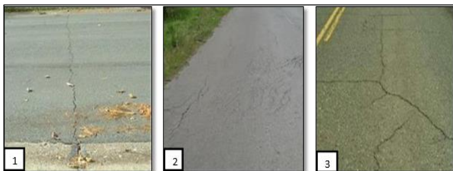
Fisura de contracción térmica
