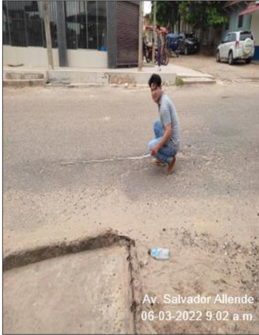
Fotografía 13. Tramo X Progresiva del 0+1080 al 0+1090 Se puede observar el deterioro tipo "B" fisura longitudinal por fatiga.
