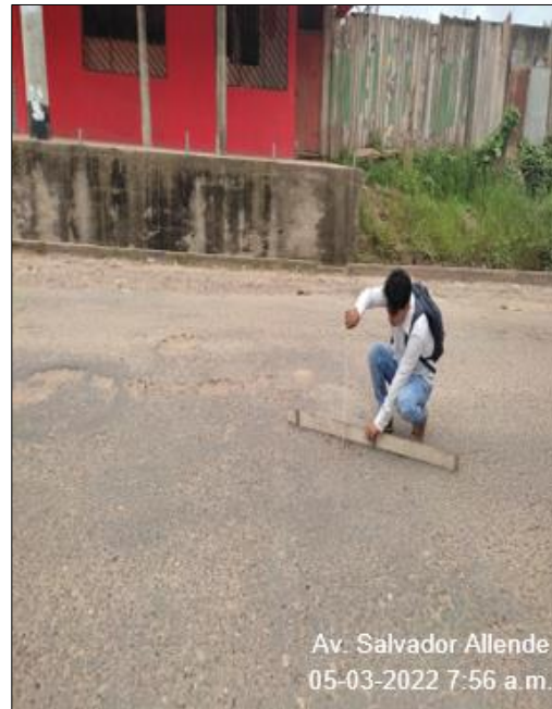
Fotografía 12. Tramo VI Progresiva del 0+600 al 0+700 Se puede observar el deterioro tipo "B" ojo de pescado.
