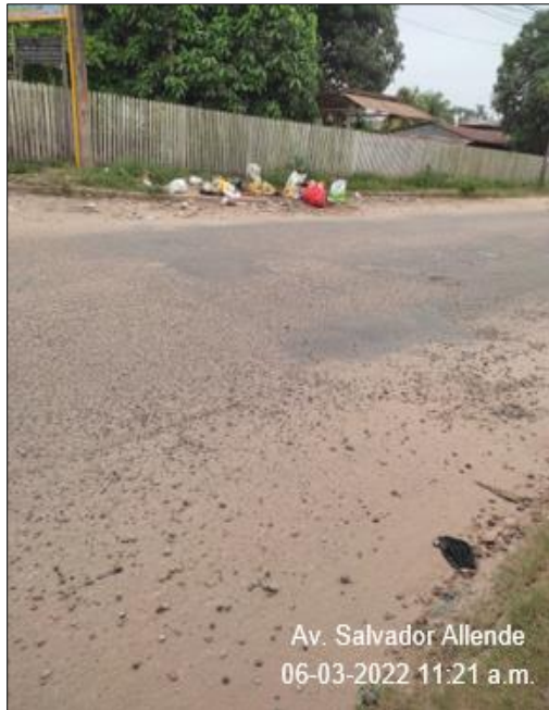
Fotografía 15. Tramo XV Progresiva del 0+1390 al 0+1490 Se puede observar el deterioro tipo "A" bacheo y parcheo.
