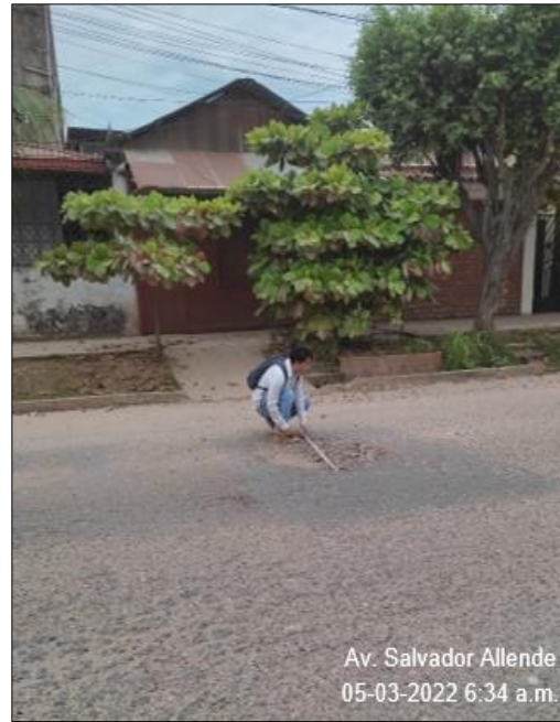
Fotografía 06. Tramo I Progresiva del 0+000 al 0+100 Se puede observar el deterioro tipo "B" ojo de pescado.
