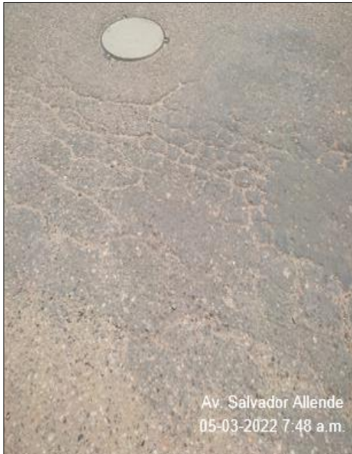
Fotografía 11. Tramo VI Progresiva del 0+600 al 0+700 Se puede observar el deterioro tipo "A" fisura piel de cocodrilo.
