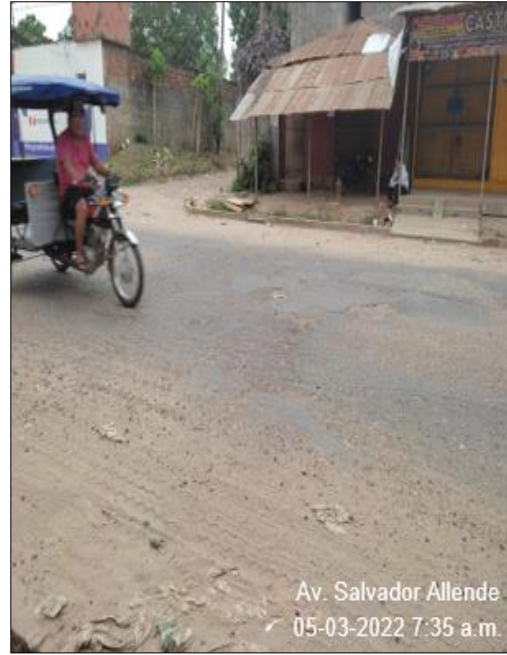
Fotografía 10. Tramo IV Progresiva del 0+400 al 0+500 Se puede observar el deterioro tipo "B" ojo de pescado.
