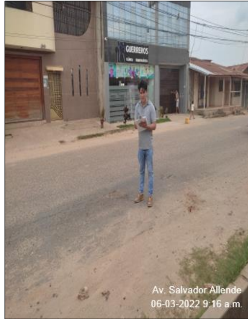
Fotografía 14. Tramo X Progresiva del 0+1080 al 0+1090 Se puede observar el deterioro tipo "B" ojo de pescado
