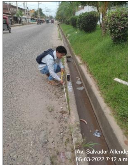
Fotografía 08. Tramo II Progresiva del 0+200 al 0+300 Se puede observar el deterioro tipo "B" Desintegración de borde de pavimento.
