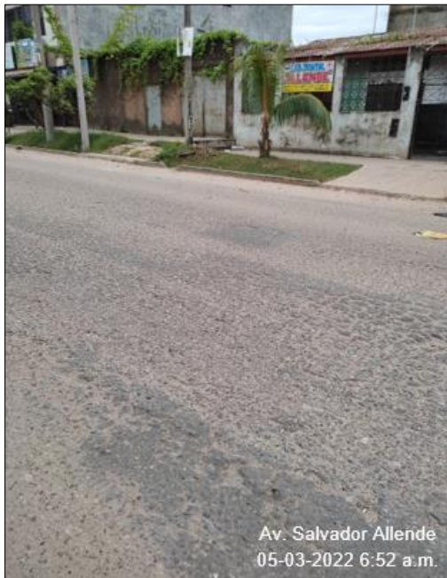
Fotografía 07. Tramo II Progresiva del 0+200 al 0+300 Se puede observar el deterioro tipo "A" fisura piel de cocodrilo.
