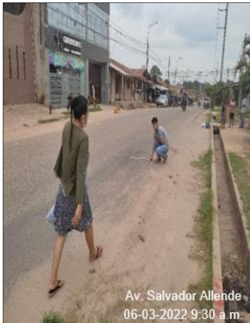
Fotografía 15. Tramo XI Progresiva del 0+1090 al 0+1190 Se puede observar el deterioro tipo "B" fisura longitudinal por fatiga.
