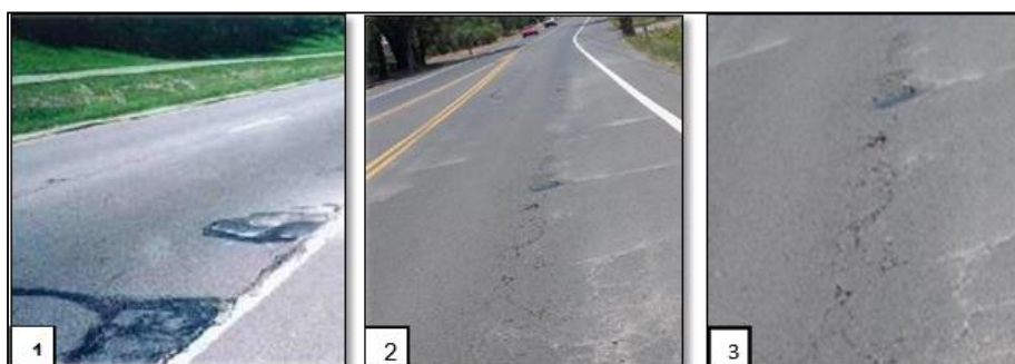
Afloramiento de mortero
