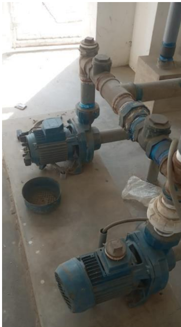
Figura 08. Bombas de Abastecimiento a Tanque Elevado
