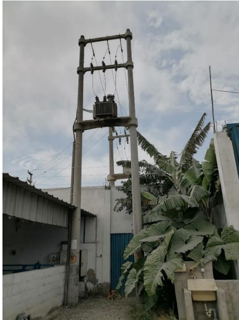
Anexo 4: placa de transformador de distribución 250 KVA
