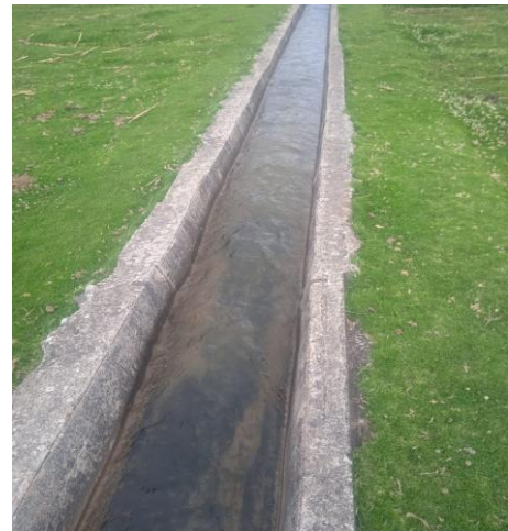
Figura 2: Deterioro de superficie de canal
