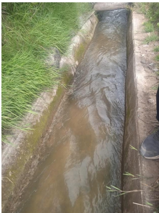
En la figura se presenta el canal con presencia de algas y vegetación
