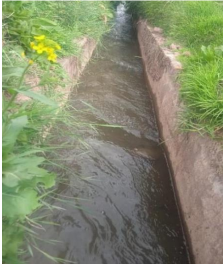
Figura 11: Se aprecia presencia de sedimentos
