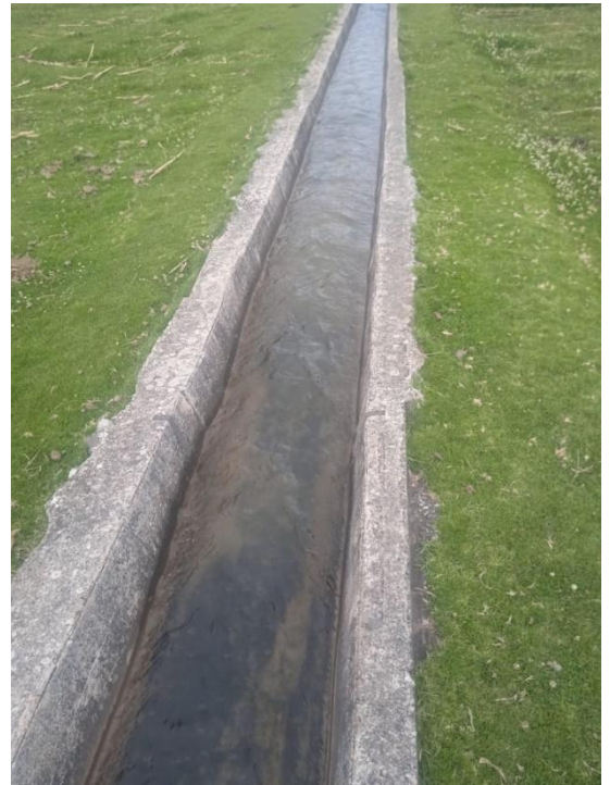
En la figura se presenta el canal con sedimentos y desgaste de materia
