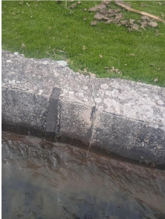
En la figura se presenta el canal con desgaste de superficie
