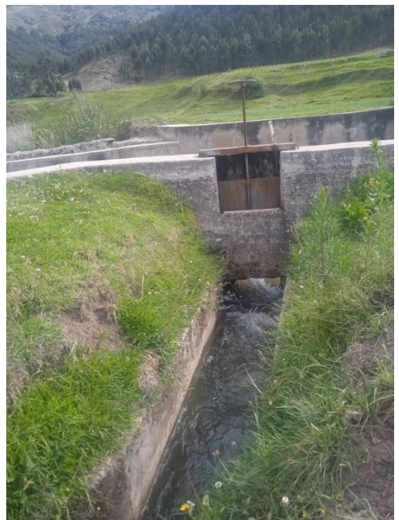
En la figura se aprecia la entrada del canal con desgaste de superficie
