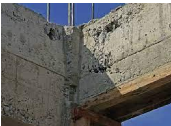
Figura 3. Segregación en estructuras de concreto Fuente: Aceros Arequipa (2018)
