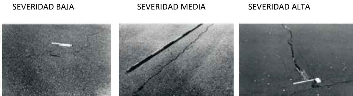
Figura 11. Grietas longitudinales y transversales.
