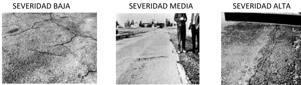
Figura 5. Abultamiento y hundimiento.
