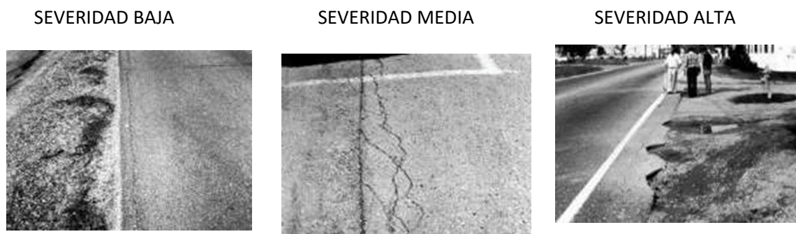
Figura 8. Grietas de borde.
