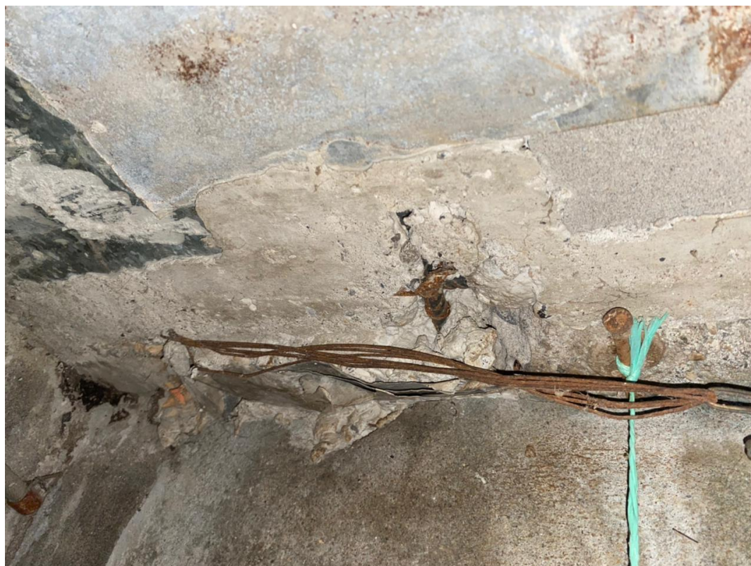
Figura 1. Fallas en el concreto en el distrito de Copallín – Bagua
