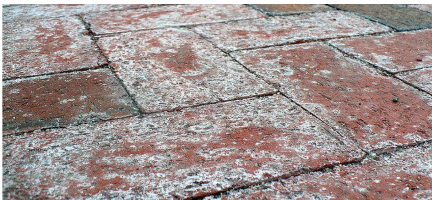
Figura 6. Eflorescencia en Ladrillo. Chapman-Bell (2004)
