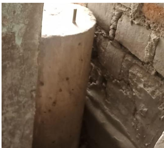
Figura 32. Inadecuado espesor de mortero.
