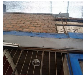
Figura 17. Deterioro del acero ala intemperie.
