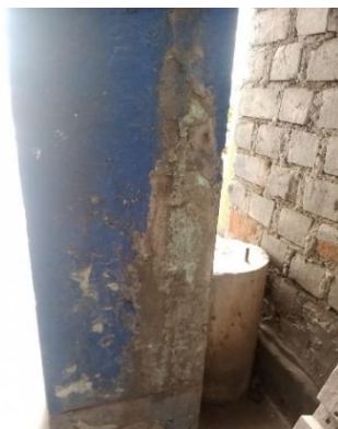
Figura 13. Fisuras en columnas.
