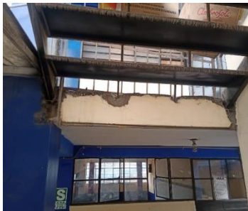
Figura 16. Fisuras y exposición del acero en losa del Pab. "A".
