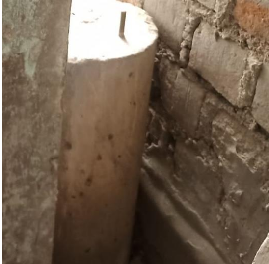
Figura 33. Unidad de ladrillos en mal estado.
