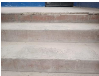
Figura 18. Cangrejas en losa.
