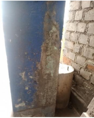
Figura 14. fisura en columna
