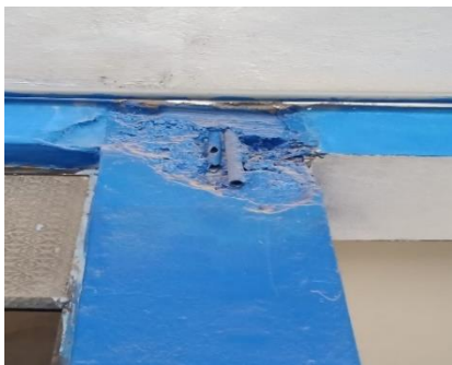
Figura 12. Desprendimiento del recubrimiento y cangrejas en vigas.
