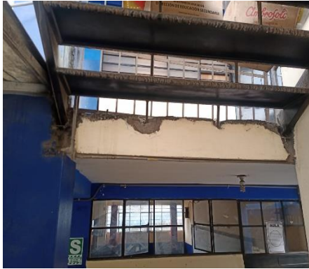
Figura 11. Perdida de recubrimiento en las escaleras.
