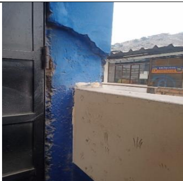
Figura 8. Exceso de recubrimiento de tarrajeo y exposición del acero.
