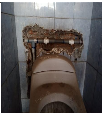
Figura 10. Exposición a la infiltración de humedad.
