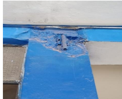
Figura 15. Fisuras y desprendimiento en columna- Pab "A".
