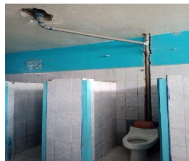
Figura 19. ruptura del techo y muro del Pab "A".
