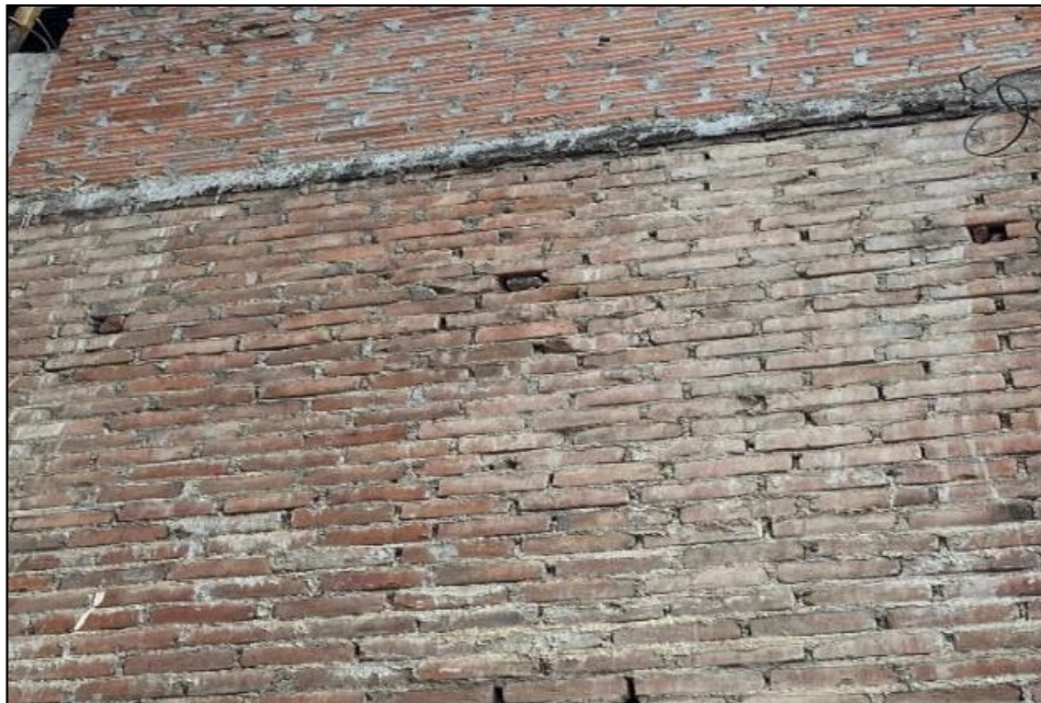
Figura 50. Vivienda con densidad de muros inadecuados
