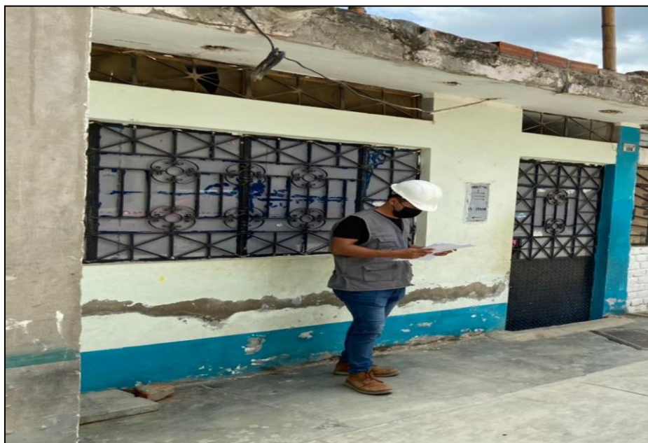
Figura 51. Vivienda con presencia de humedad en los muros
