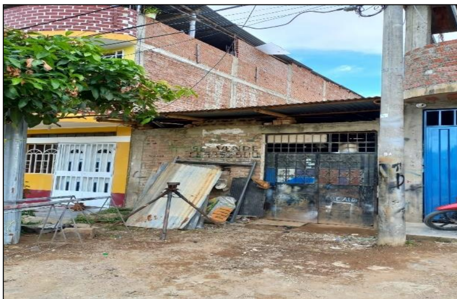
Figura 20. Vivienda N°010 del lote 002, cubierta inestable de la vivienda – no asegura un diafragma rígido
