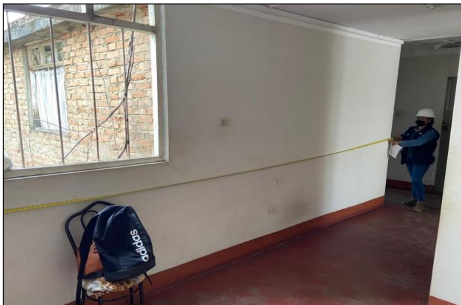
Figura 18. Vivienda N°0016 del lote 0045, medición de separación máxima entre muros
