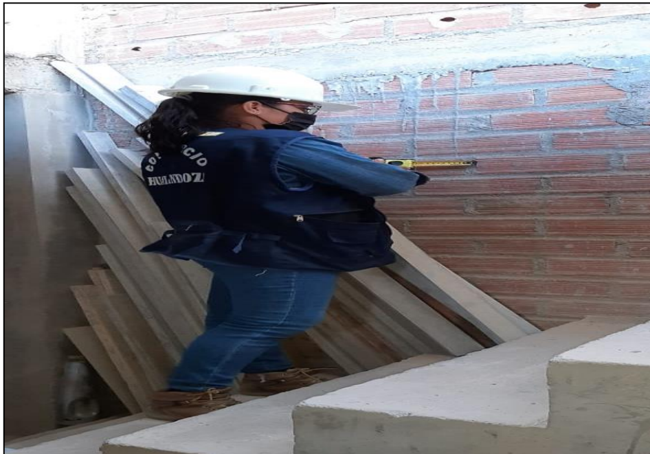
Figura 6. Vivienda N° 010 del lote 002, muro de ladrillo artesanal, con espesores mayores a 2cm.
