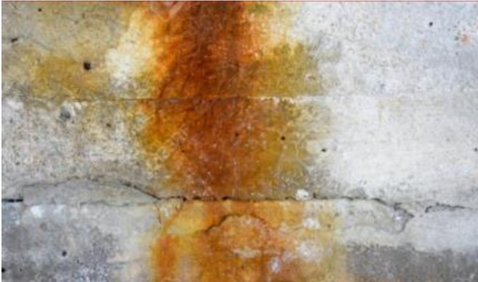
Figura 3: Columna En Estado De Oxidación
