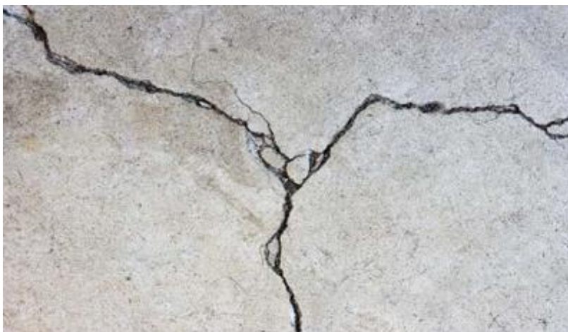
Figura 1: Fotografía De Grieta En Columna
