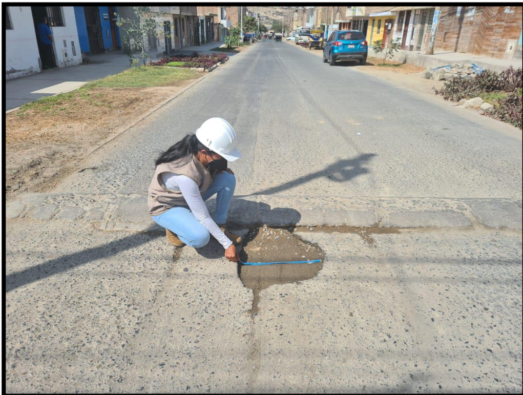
Identificación y medición de falla a lo largo de la calzada.
