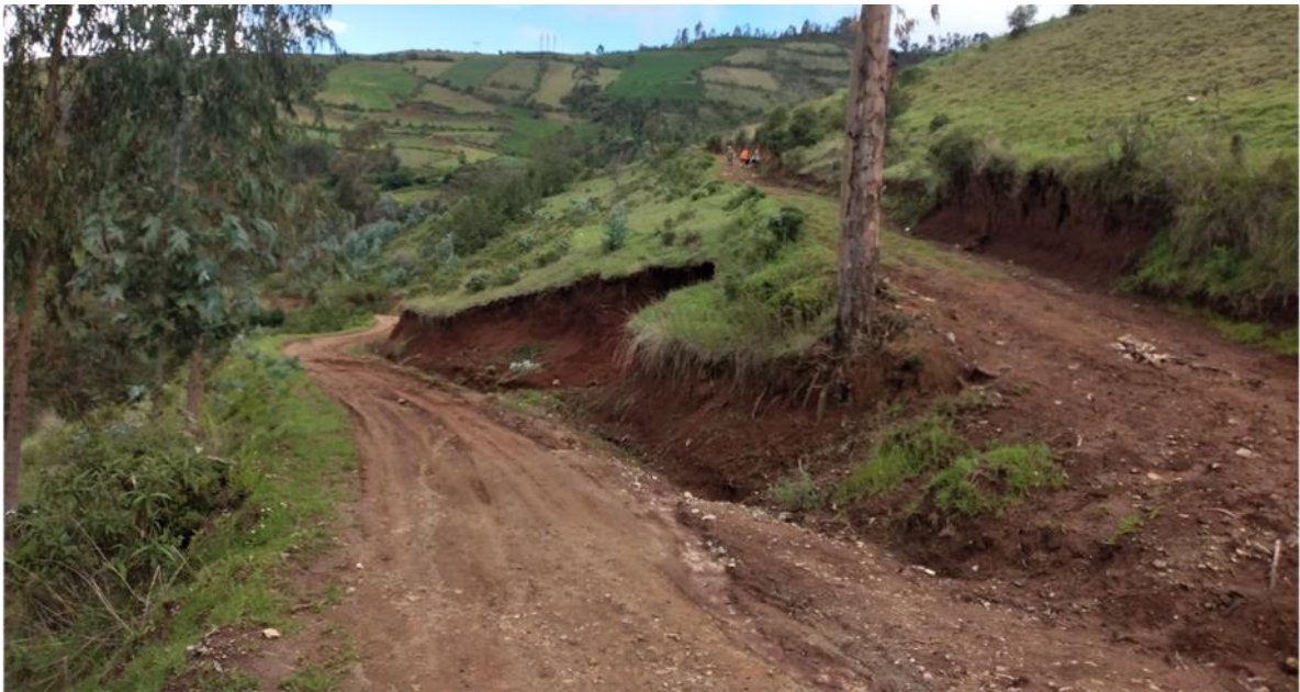
Figura 13: en la figura se muestra el ramal de inicio de carretera que existe su plataforma, en 300 metros
