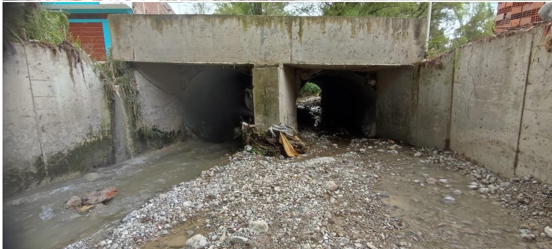
Identificación Pontón losa 2 ojos Alcantarilla de 1.50m c/u y de condición Excelente a nivel estructural, con antigüedad de ejecución de 2 años entre la progresiva 00+920.00 – 00+940.00 y su en su condición actual se muestra sedimentación lateral, que obstruye mínimo el pase del agua.
