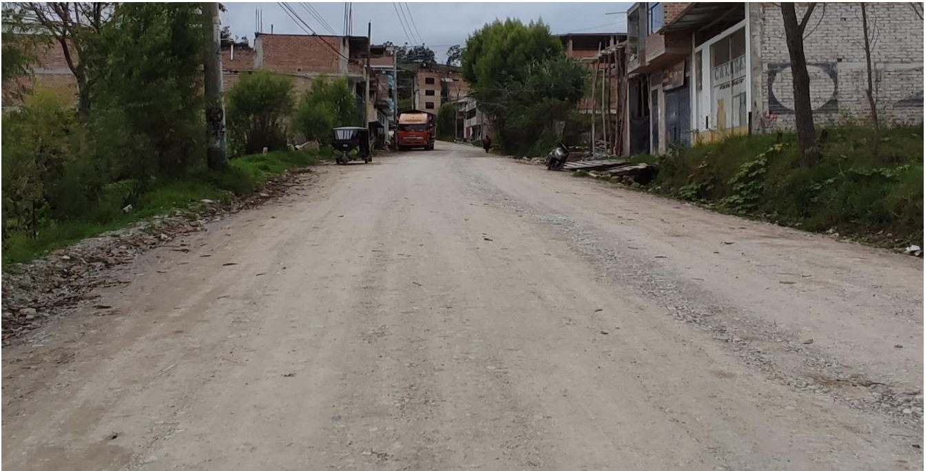
Progresiva 01+400.00 vía es buen estado, no aprecia cunetas en bordes laterales
