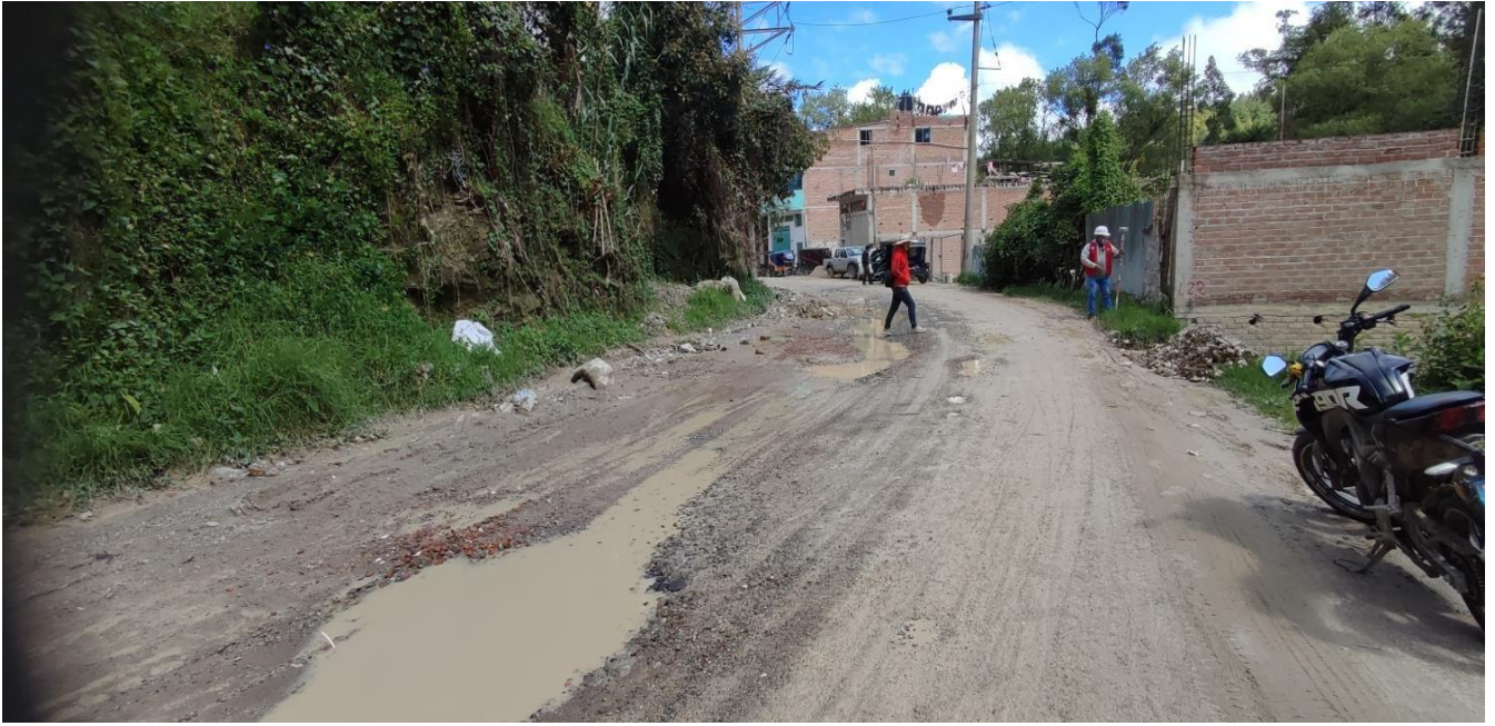
Progresiva 01+600.00 se aprecia una ladera, la cual esta mencionada como punto con riesgo de deslizamiento de ladera, y presencia de baches y deformaciones
