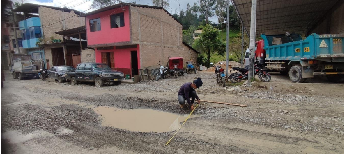
Presencia de baches (huecos) donde el agua de lluvia se retiene
