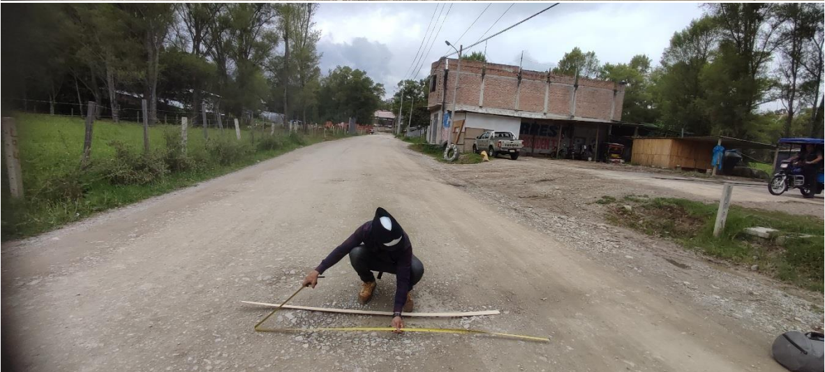
Medición de baches (huecos) identificados de pocas dimensiones en la vía
