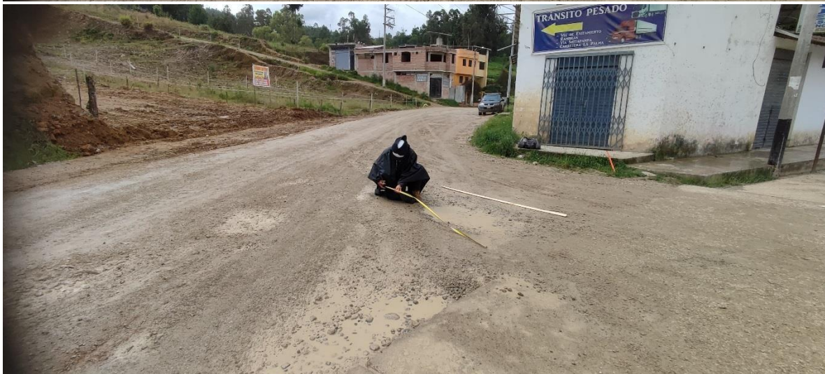
Medición de baches (huecos) identificados de pocas dimensiones en la vía, cruce Av. Inca Garcilaso de la Vega, ingreso
