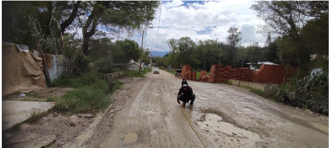
Medición de baches (huecos) identificados en la vía
