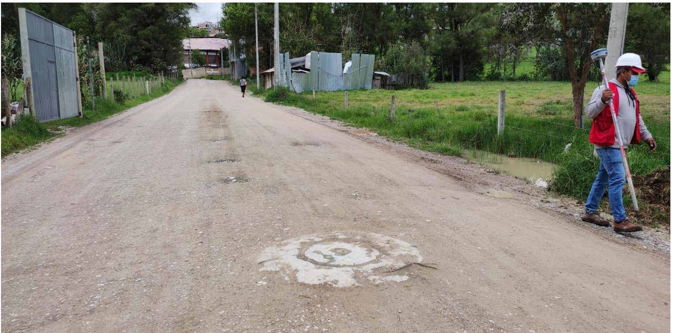
Progresiva 00+900.00 se aprecia la vía con baches y encalamiento pero en buen estado.
