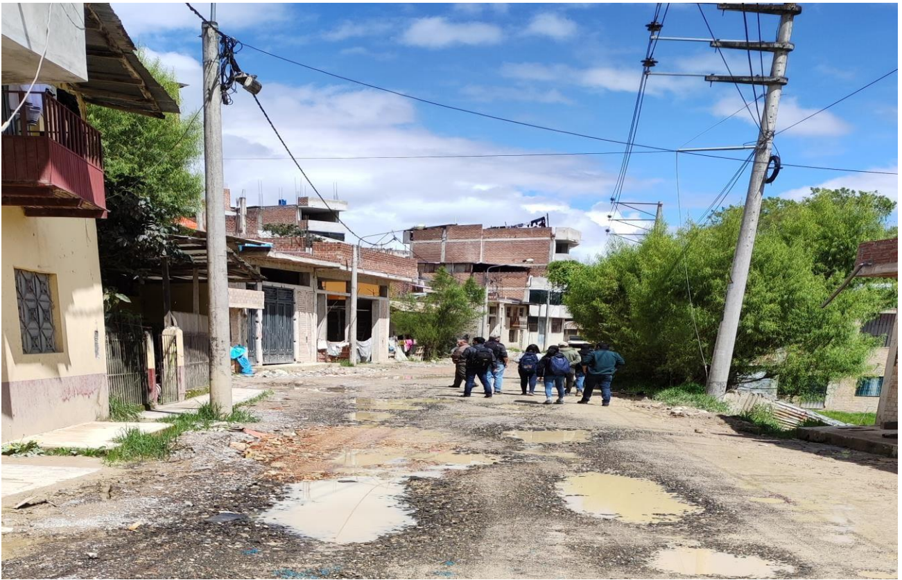
Progresiva 01+750.00 presencia de baches y lodazal en este tramo de la vía, producto de las precipitaciones y no presencia de sistema de drenaje para evacuar las aguas
