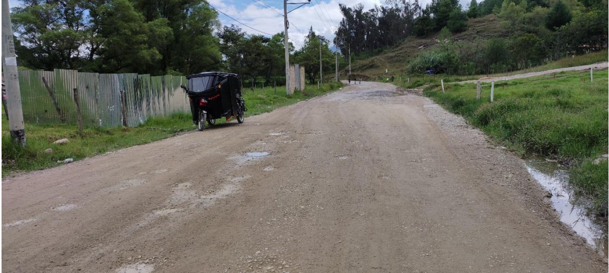
Estado de vía en buenas condiciones, ancho útil despejado, presencia de cunetas en todo su largo.
