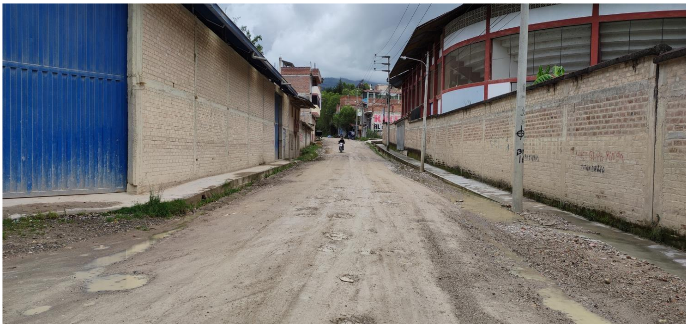
Progresiva 01+100.00 se aprecia la vía con baches, deformaciones y no se visualiza cunetas
