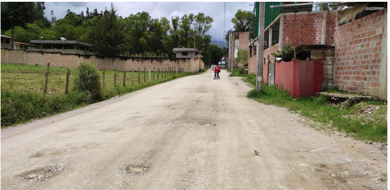
Progresiva 00+600.00 vía se identifica la presencia de Baches y enclamiento.
