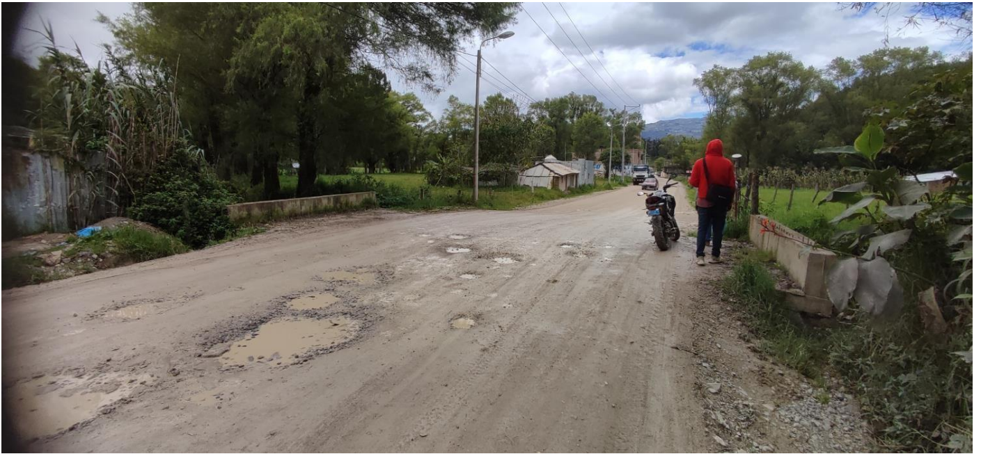
Progresiva 01+000.00 se aprecia la vía con baches, deformaciones y un Pontón alcantarilla recientemente ejecutado
