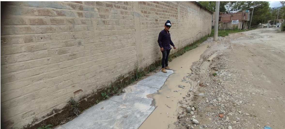
1° Imagen muestra erosión con profundidad entre 5 y 10cm y en la 2° se visualiza sedimentación acumulada al borde lateral, consecuencia de la no existencia de drenaje.
