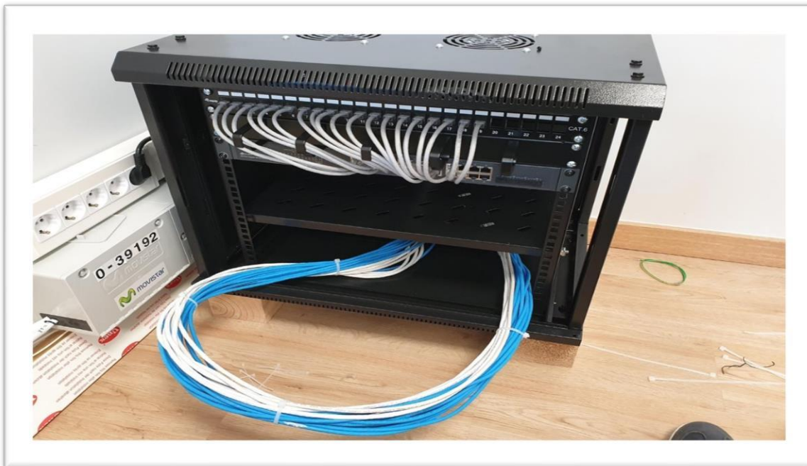
Figura 5: Interior del gabinete de red del área de hospitalización
