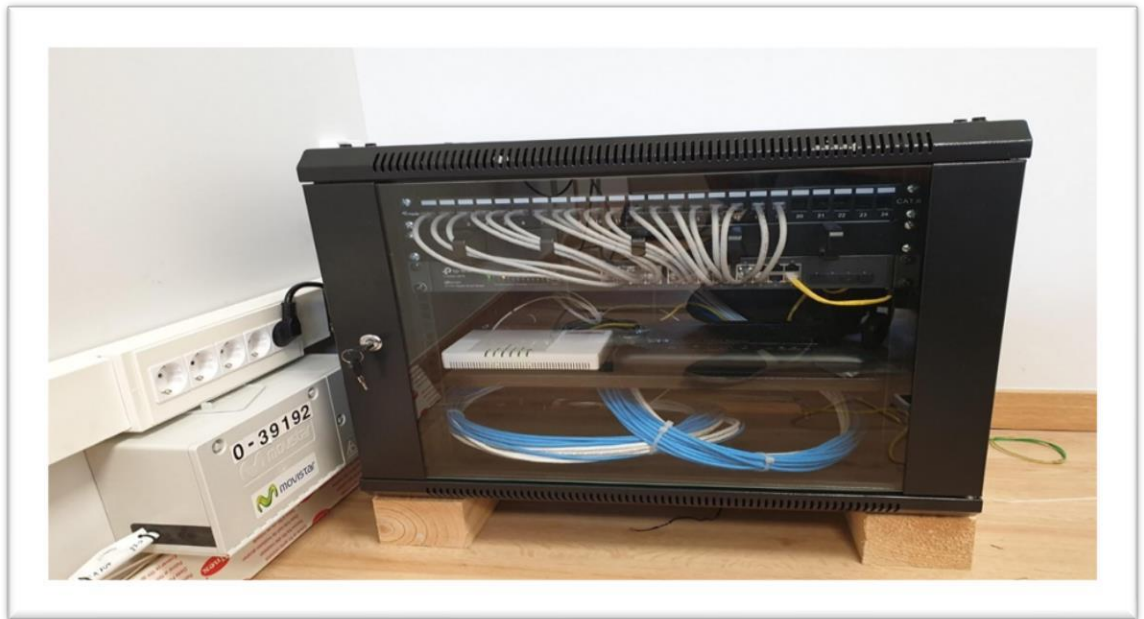
Figura 6: Interior del gabinete de red del área de emergencia
