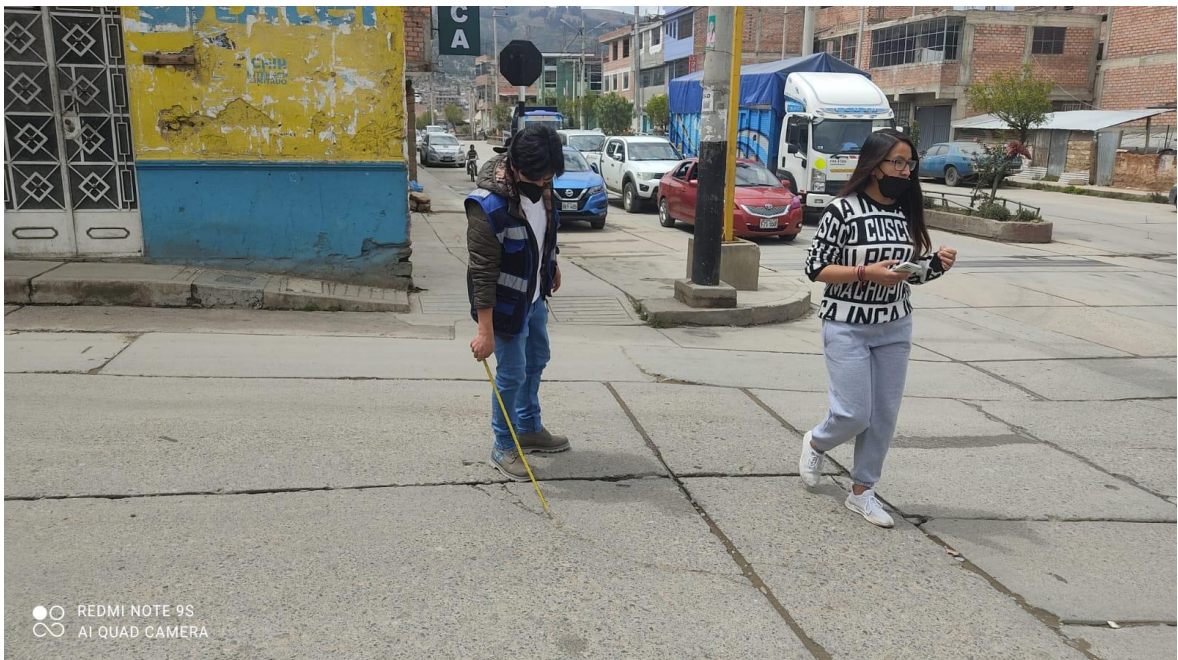
fotografía 06, se puede apreciar la falla de Grieta de Esquina de una intensidad alta.
