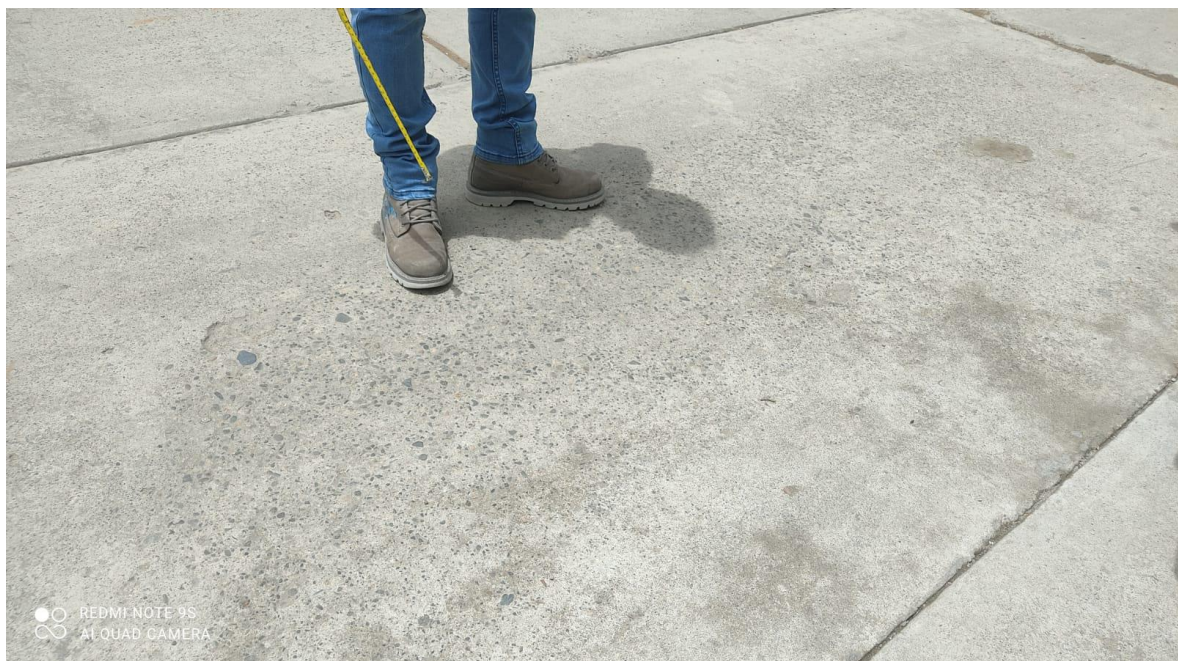
Fotografía 02, se puede apreciar la patología de pulimiento de agregados de un daño moderado.
