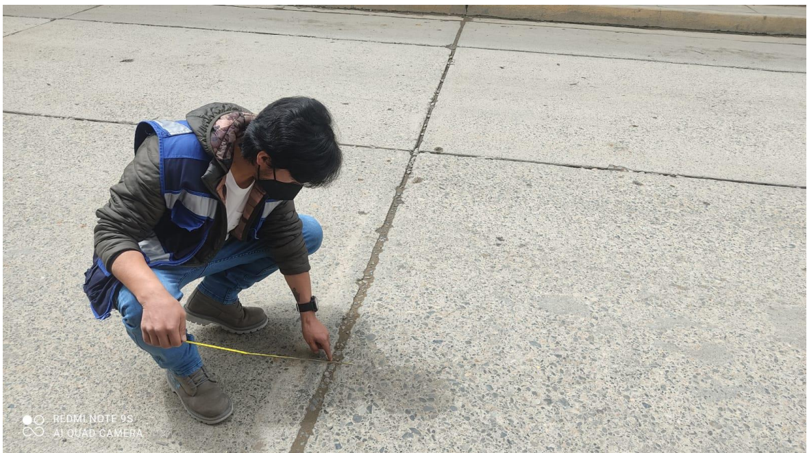
Fotografía 08, se aprecia las fallas de Daño de Sello de Junta con una intensidad moderado y se aprecia que el pavimento está afectado por la falla de Pulimiento de Agregados de una severidad alta.
