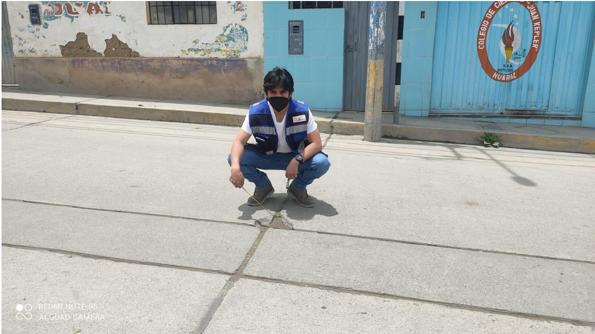
Fotografía 03, se puede apreciar que la falla de descascaramiento de Esquina de una severidad alta.
