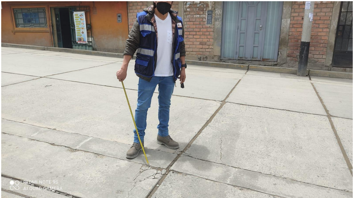
Fotografía 07, se aprecia la falla de Descascaramiento de Juntas de una severidad alta y la falla de Parcheo Grande de una intensidad moderado y la falla de Daño de Sello de Junta de una intensidad moderado.
