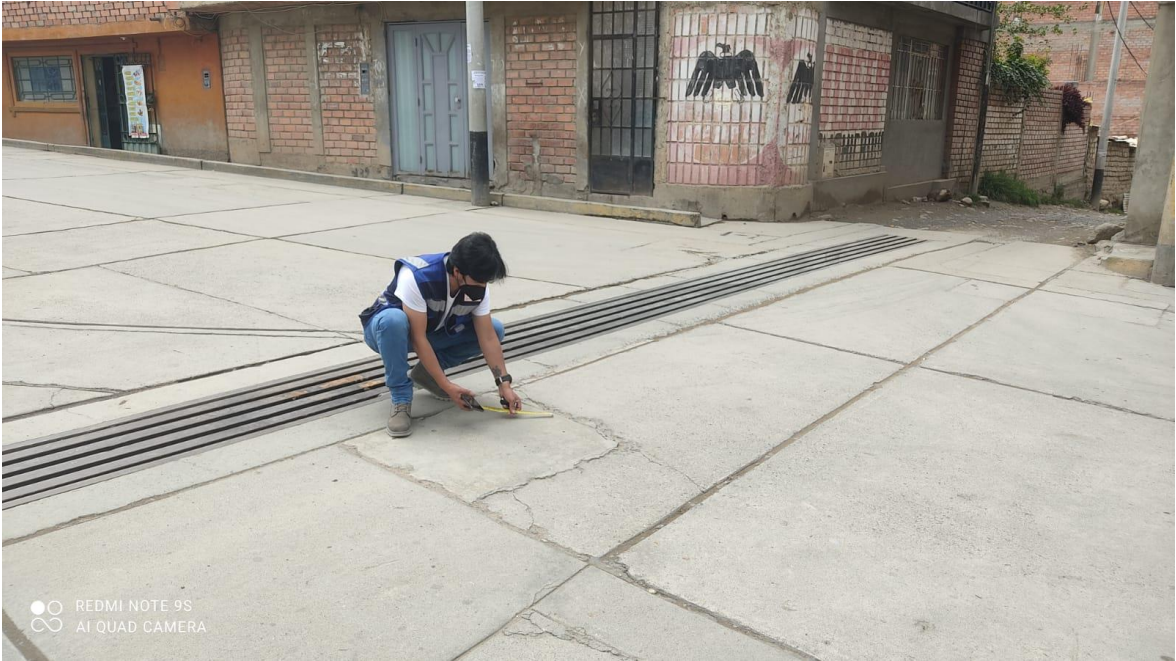
Fotografía 09, se puede apreciar la falla de Parcheo Pequeño de una intensidad alta.
