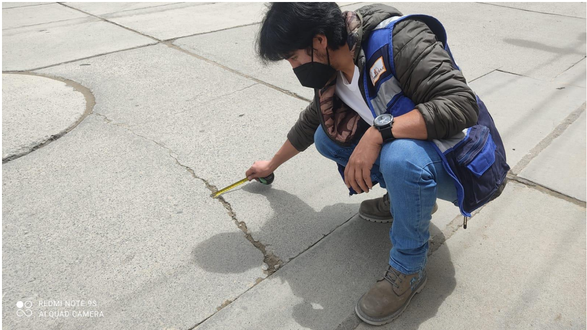
Fotografía 05, se puede apreciar la falla de Grietas lineales de una severidad alta.
