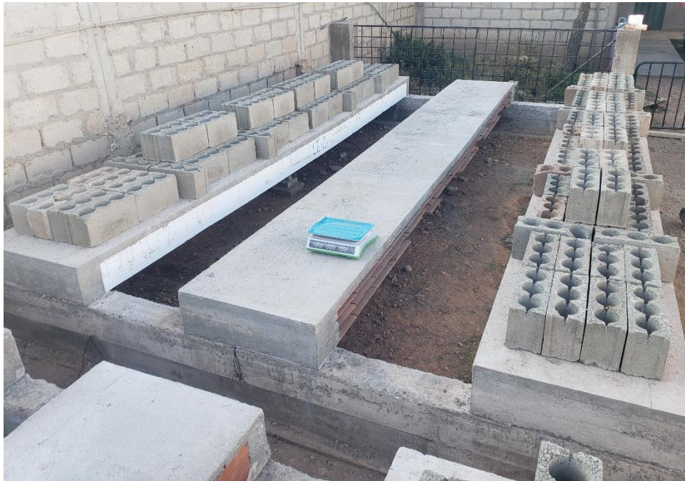
Figura 15. Aplicación de carga muerta a las losas aligeradas con bloques de EPS.
