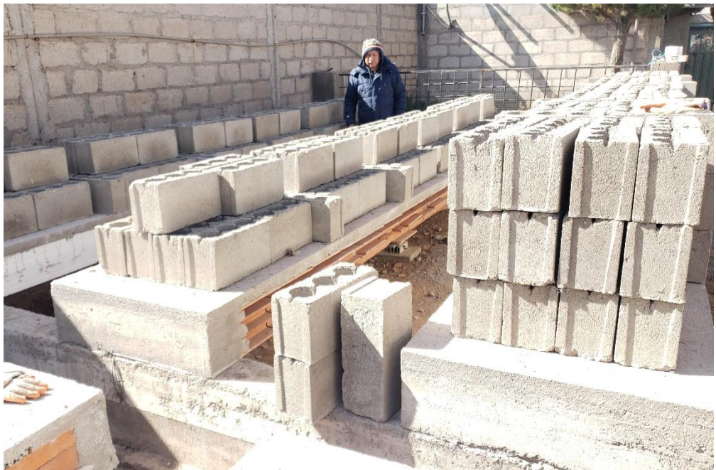
Figura 19. Aplicación de la carga por servicio a las losas aligeradas con bloques de EPS.
