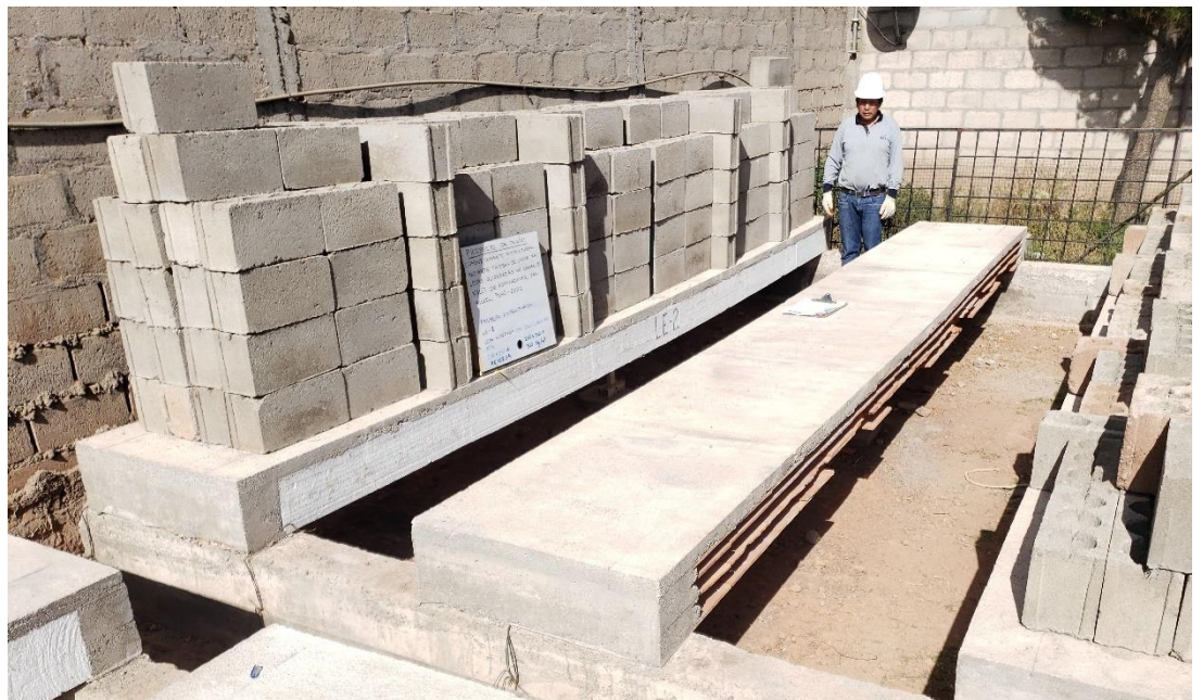
Figura 24. Aplicación de la reserva de carga por servicio a las losas aligeradas con bloques de EPS.
