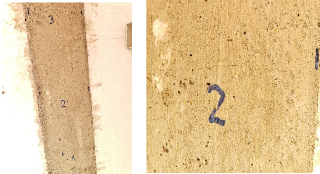
Figura 27. Fisuras en las losas aligeradas con bloques de EPS.
