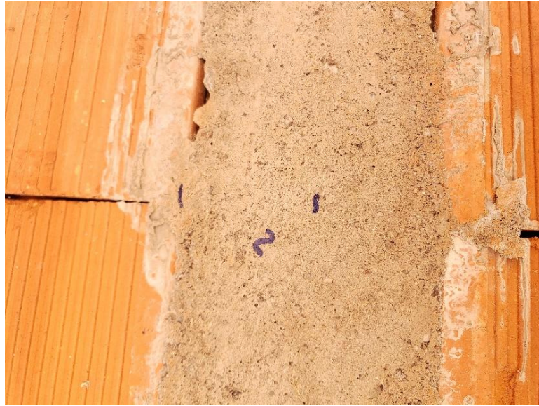
Figura 26. Fisuras en las losas aligeradas convencionales.
