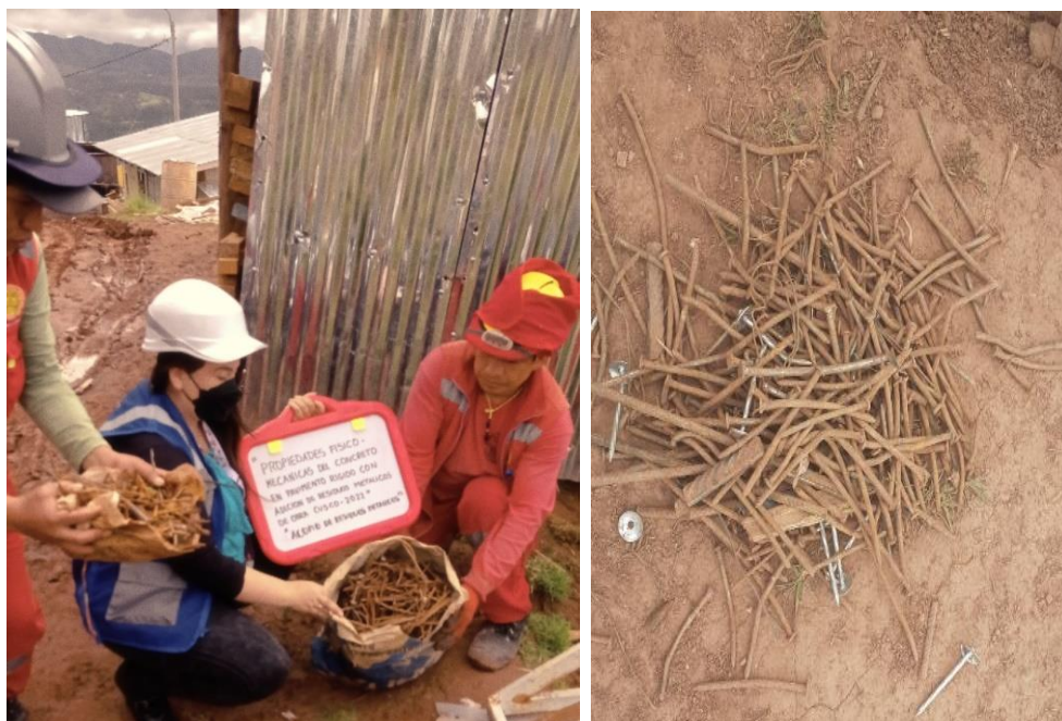
Figura 14. Acopio de RMO (clavos reciclados de encofrados: de 3" y 4" de longitud) Fuente: Bonet Maldonado, 2022
