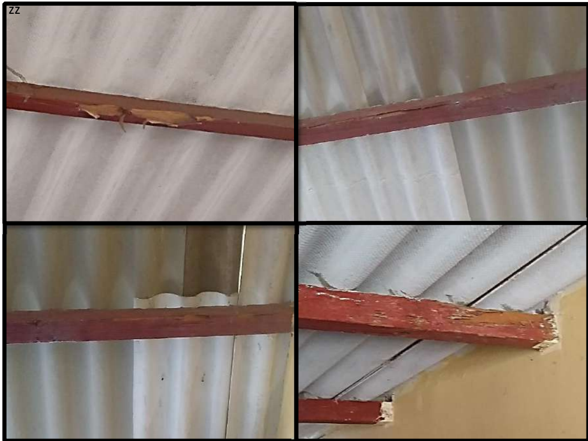
Foto N° 11. Cobertura de eternit apoyada sobre vigas de madera corroídas por la polilla.
