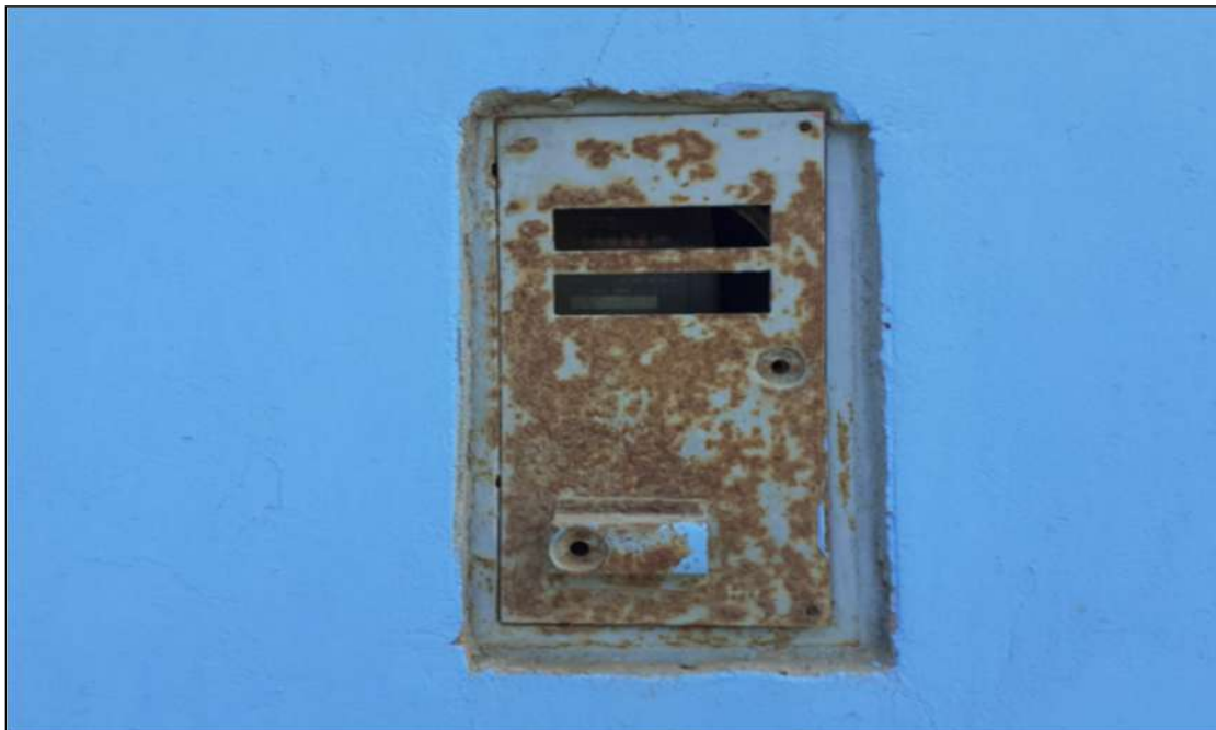
Foto 02: Medidor de energía eléctrica ubicado en fachada de Institución Educativa.
