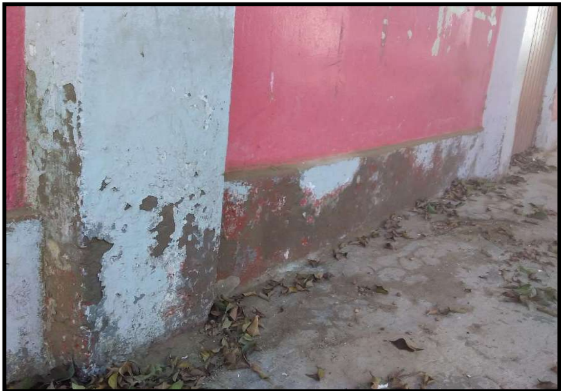
Foto N° 14. Columnas y sobre bases corroídas por la humedad y el salitre.
