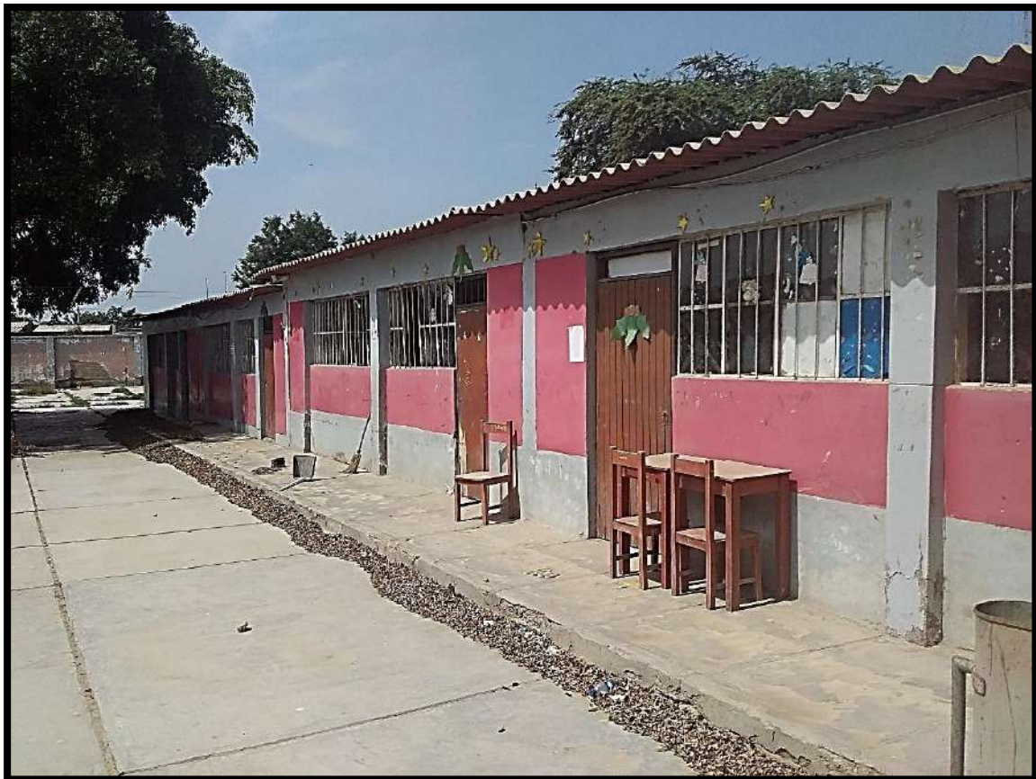
Foto N° 08. Pabellón 2, compuesto por 04 Aulas construidas de material noble y techo de eternit, puertas de madera y ventanas de fierro con vidrio no laminado y/o templado.
