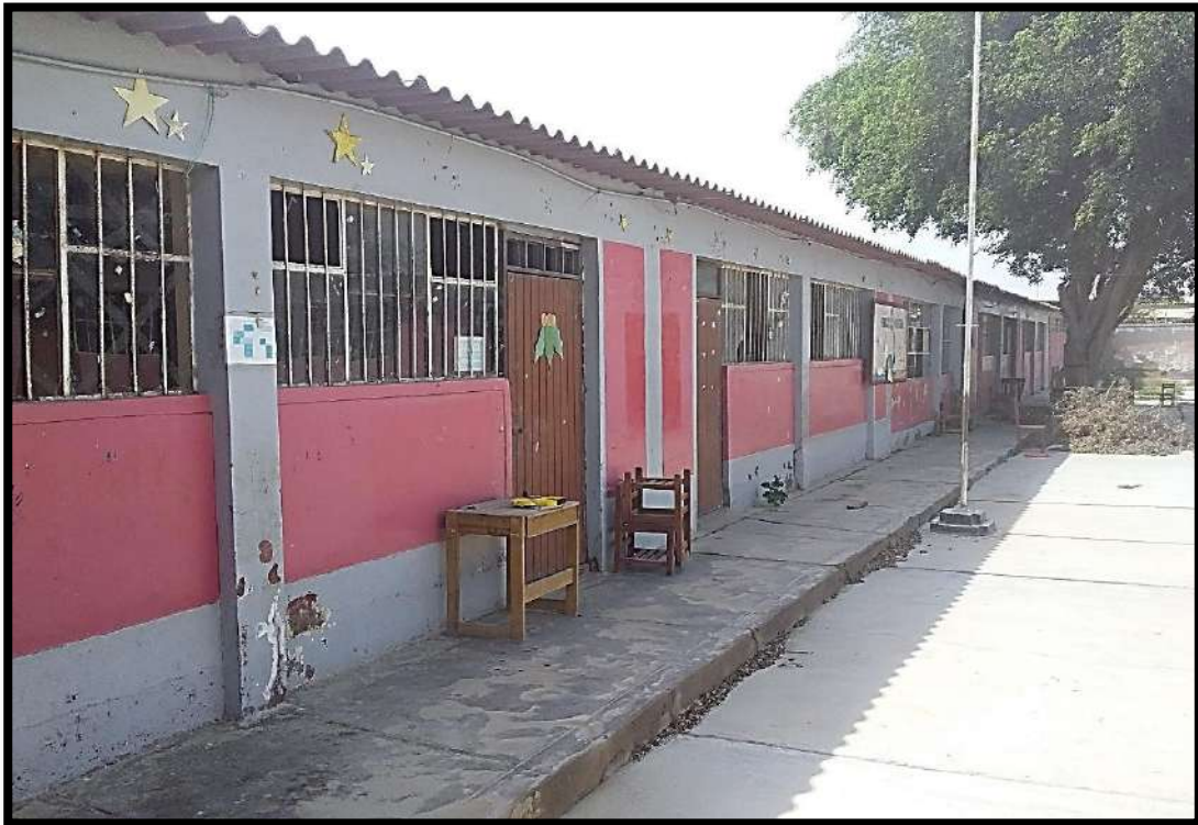
Foto N° 07. Pabellón 1, compuesto por 07 Aulas construidas de material noble y techo de eternit, puertas de madera y ventanas de fierro con vidrio no laminado y/o templado.
