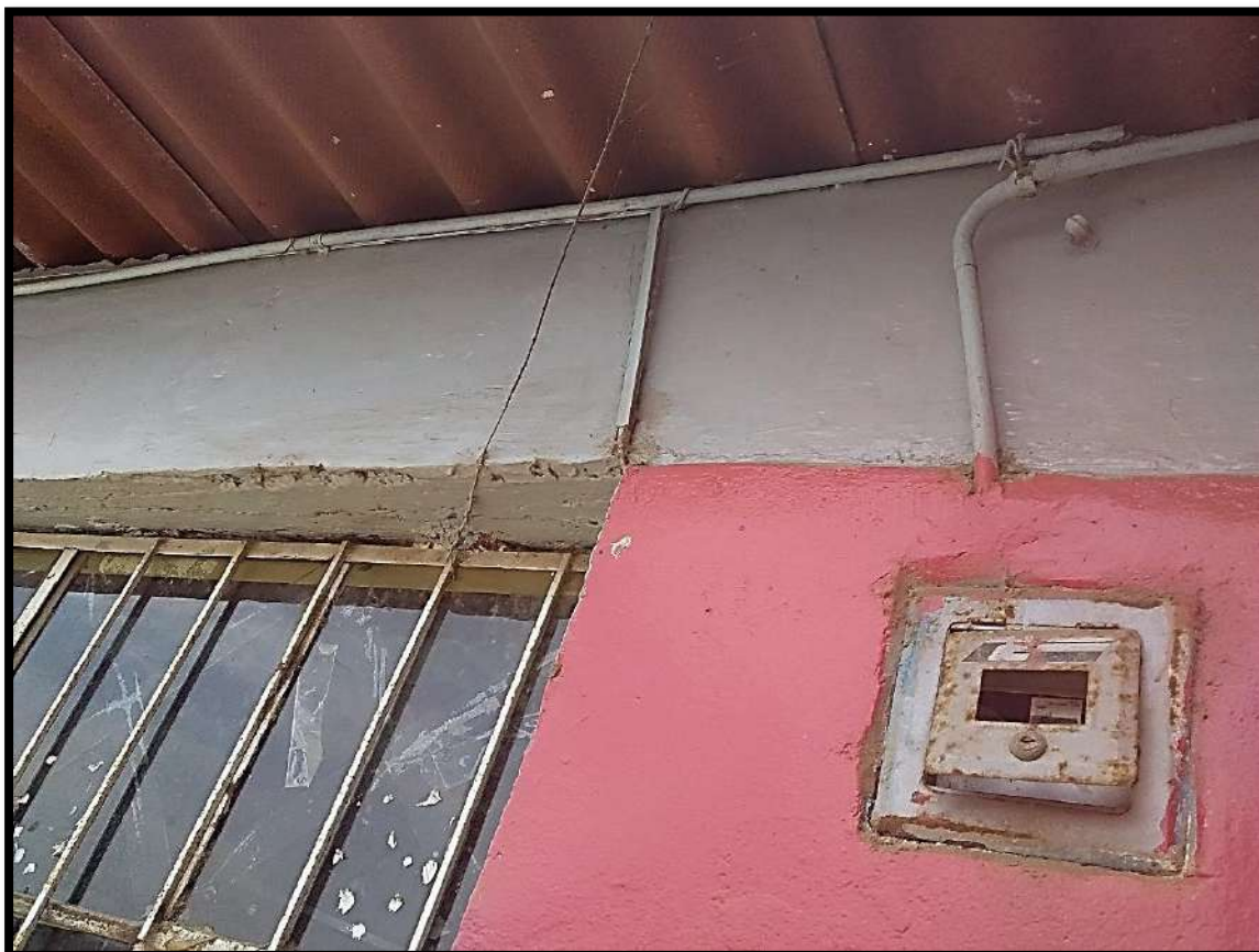
Foto N° 22. Instalaciones eléctricas realizadas por mano de obra no calificada.
