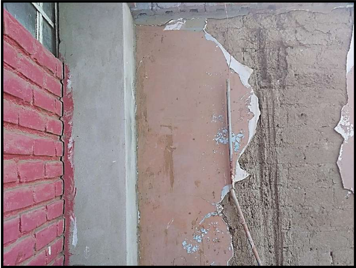
Foto N° 29. Muro de adobe en peligro de colapso. Representa un riesgo para la población estudiantil.
