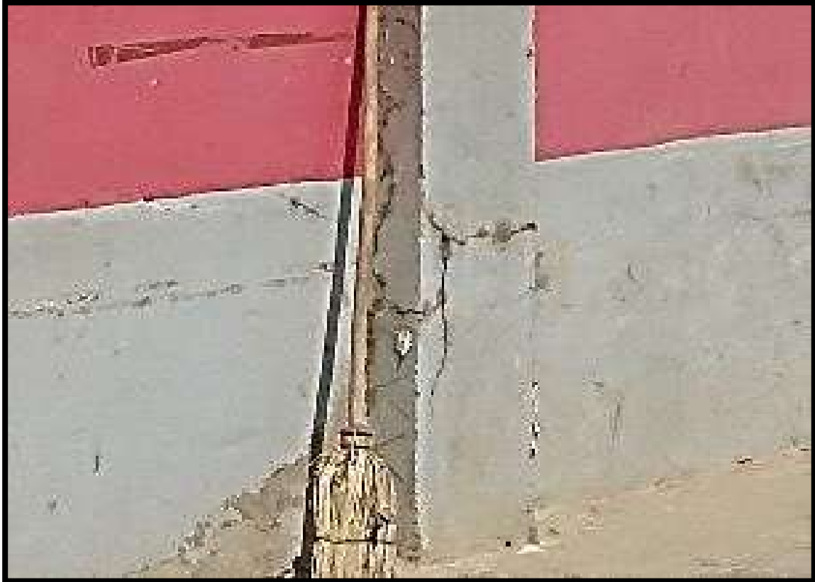
Foto N° 13. Columnas agrietadas debido a la antigüedad de su construcción.
