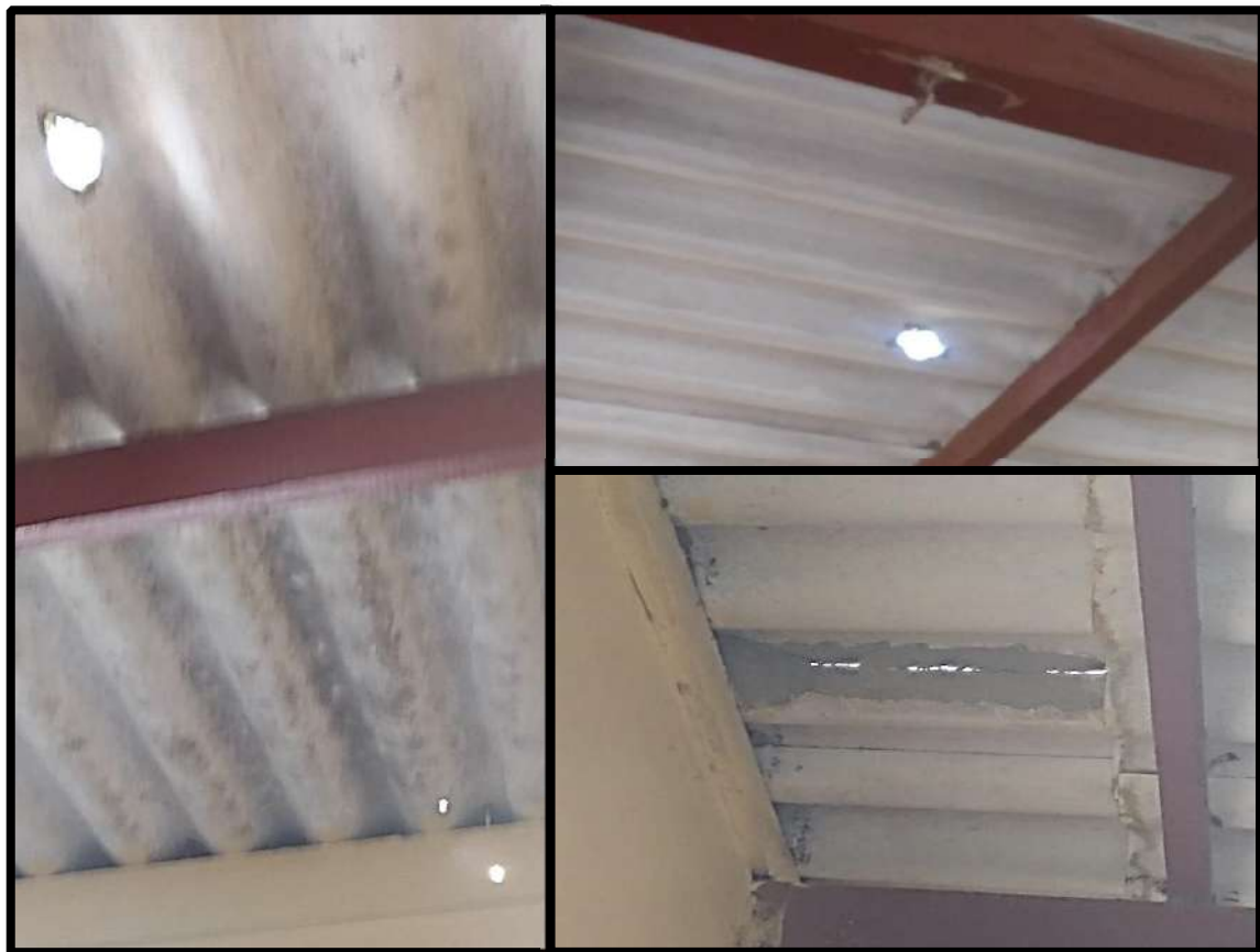
Foto N° 12. Cobertura de eternit en mal estado.
