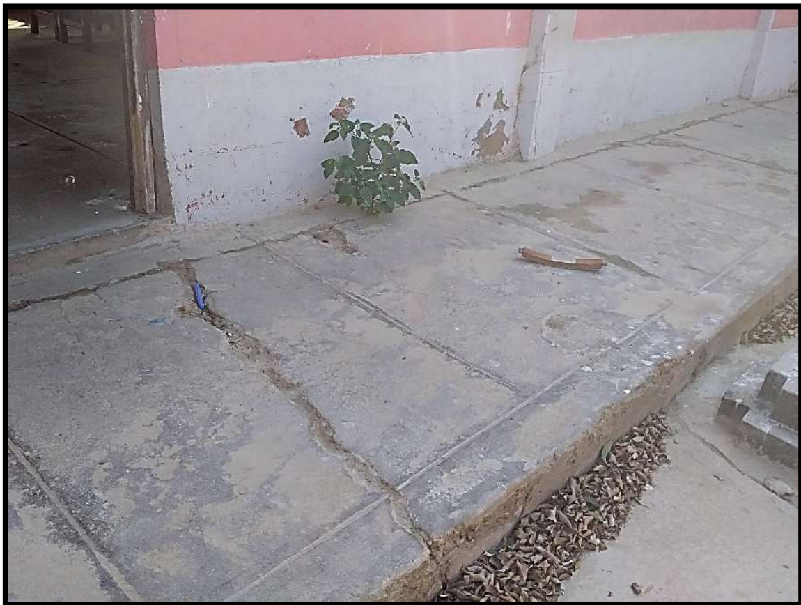
Foto N° 20. Grietas en las veredas.
