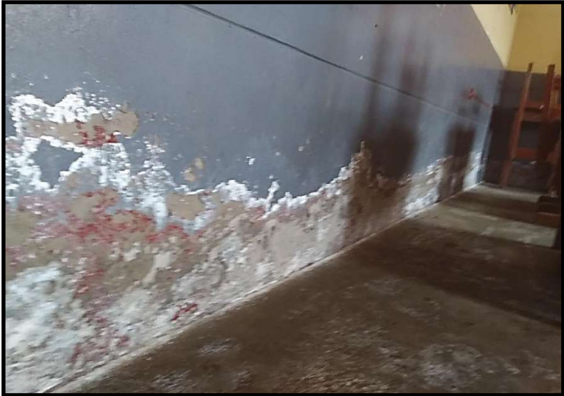
Foto N° 15. Muros corroídos por la humedad y el salitre.
