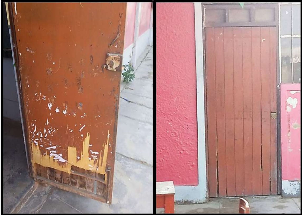
Foto N° 09. Puertas de madera en pésimo estado, no cumplen con las dimensiones mínimas normativas.
