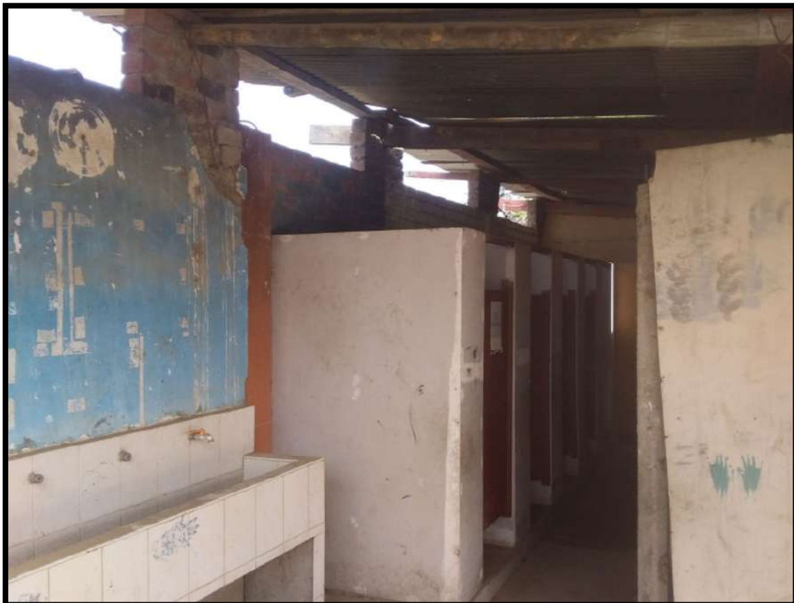
Foto N° 28. Baño de niñas. No cuentan con mantenimiento.
