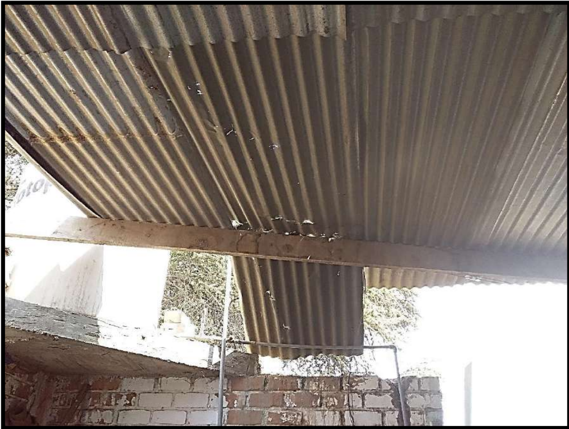
Foto N° 25. Techo de calamina del almacén en pésimo estado.
