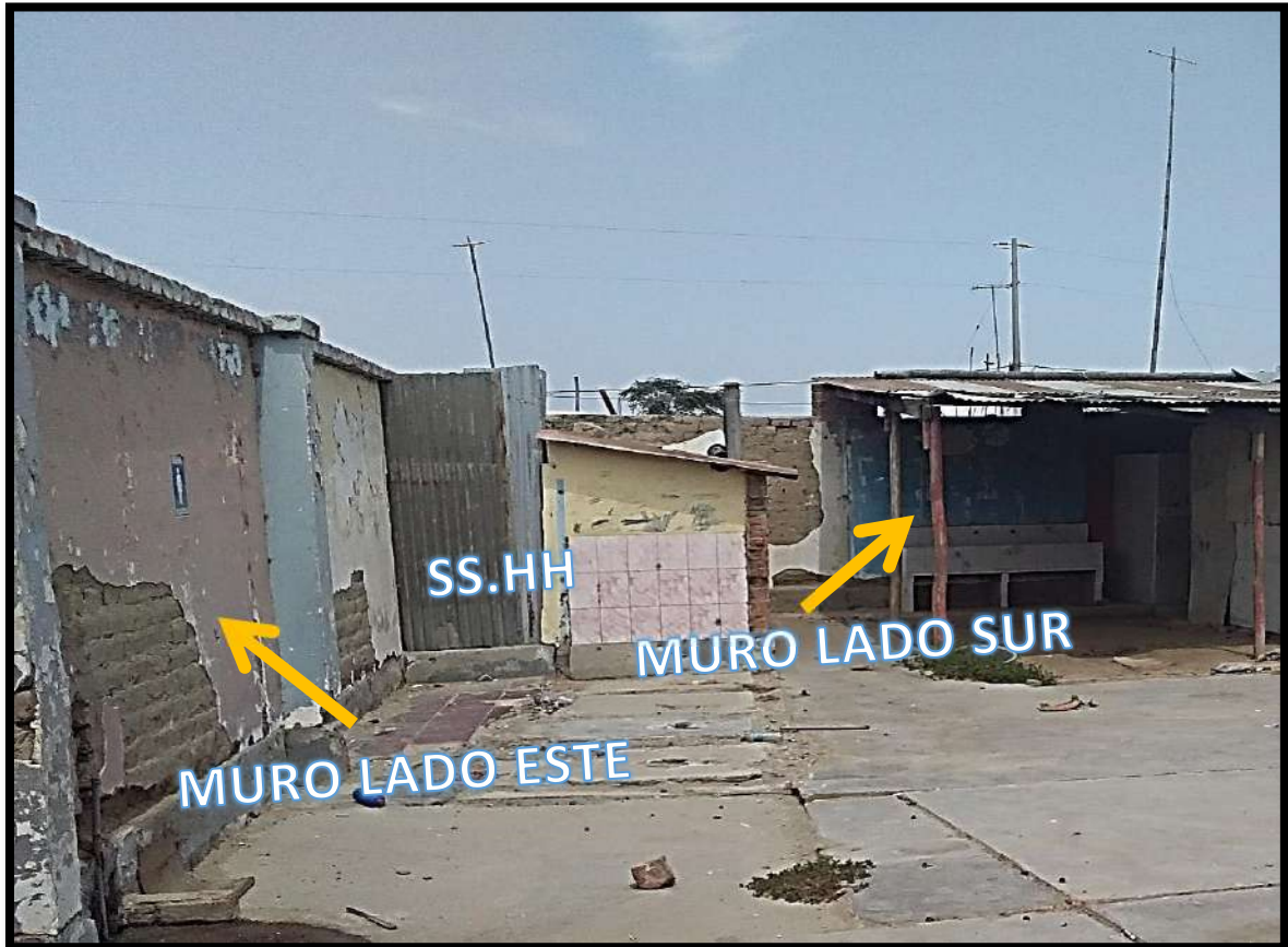
Foto N° 31. Cerco perimétrico (lado Este y Sur) construido de adobe, se encuentra en peligro de colapso, poniendo en riesgo la vida de los niños.
