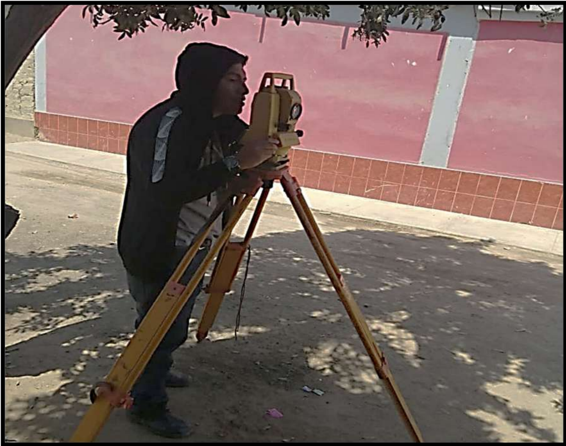
Foto N° 03. Topógrafo con Estación Total Topcom 320 , realizando trabajos en la parte exterior de la institución educativa
