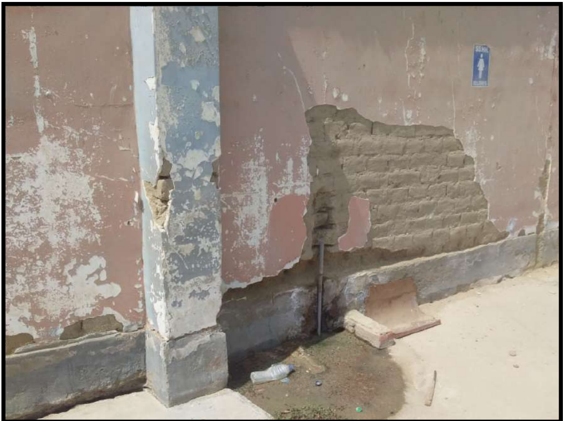
Foto N° 30. Muro de adobe en peligro de colapso. Representa un riesgo para la población estudiantil.
