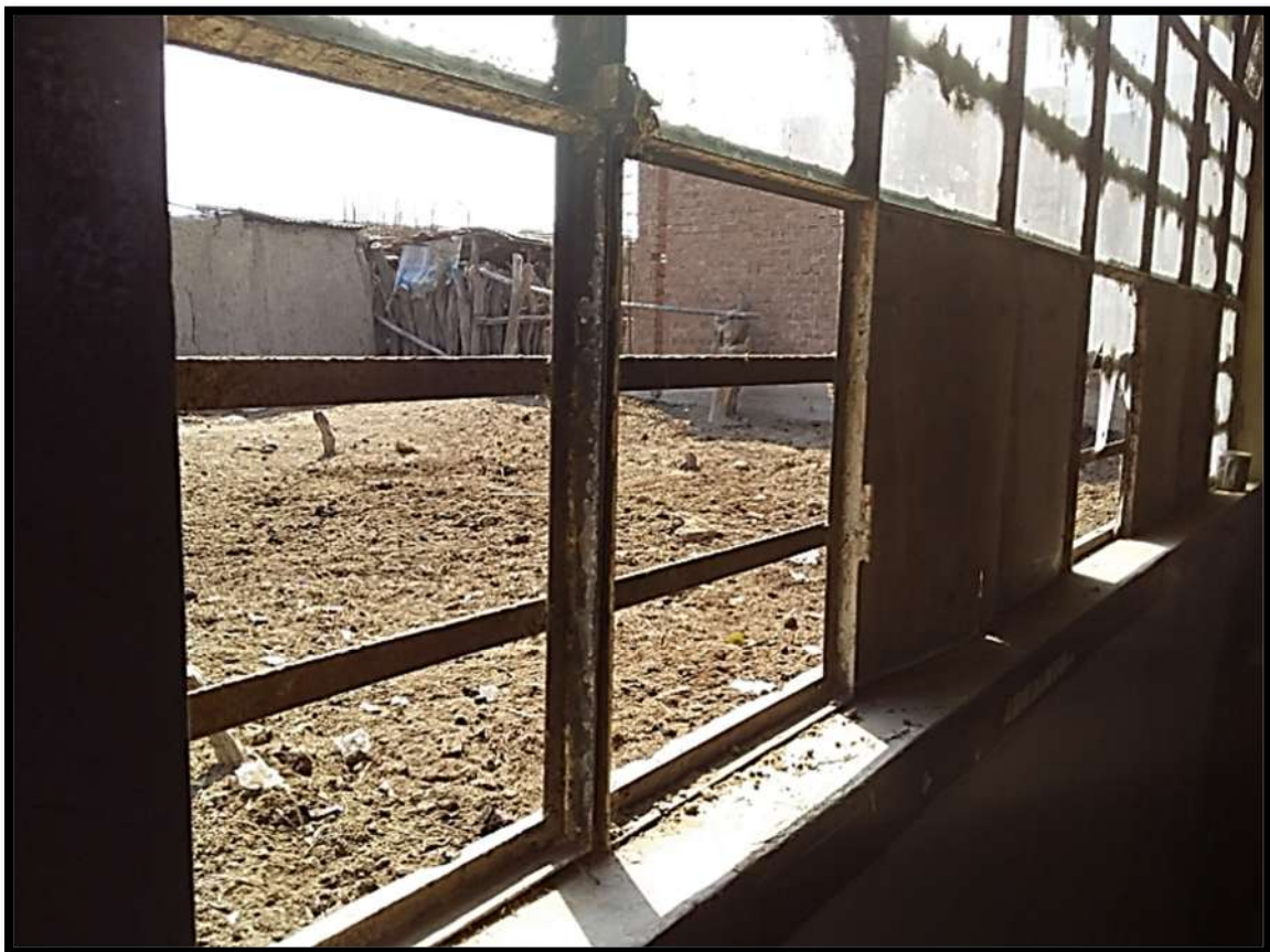
Foto N° 10. Aula colindante a un terreno solar utilizado como corral para ganados, es por ello que se precisa que estos ambientes no cumplen con el confort ambiental para su saludable estancia, pudiendo perjudicar la salud de los niños y personal que labora en esta institución.
