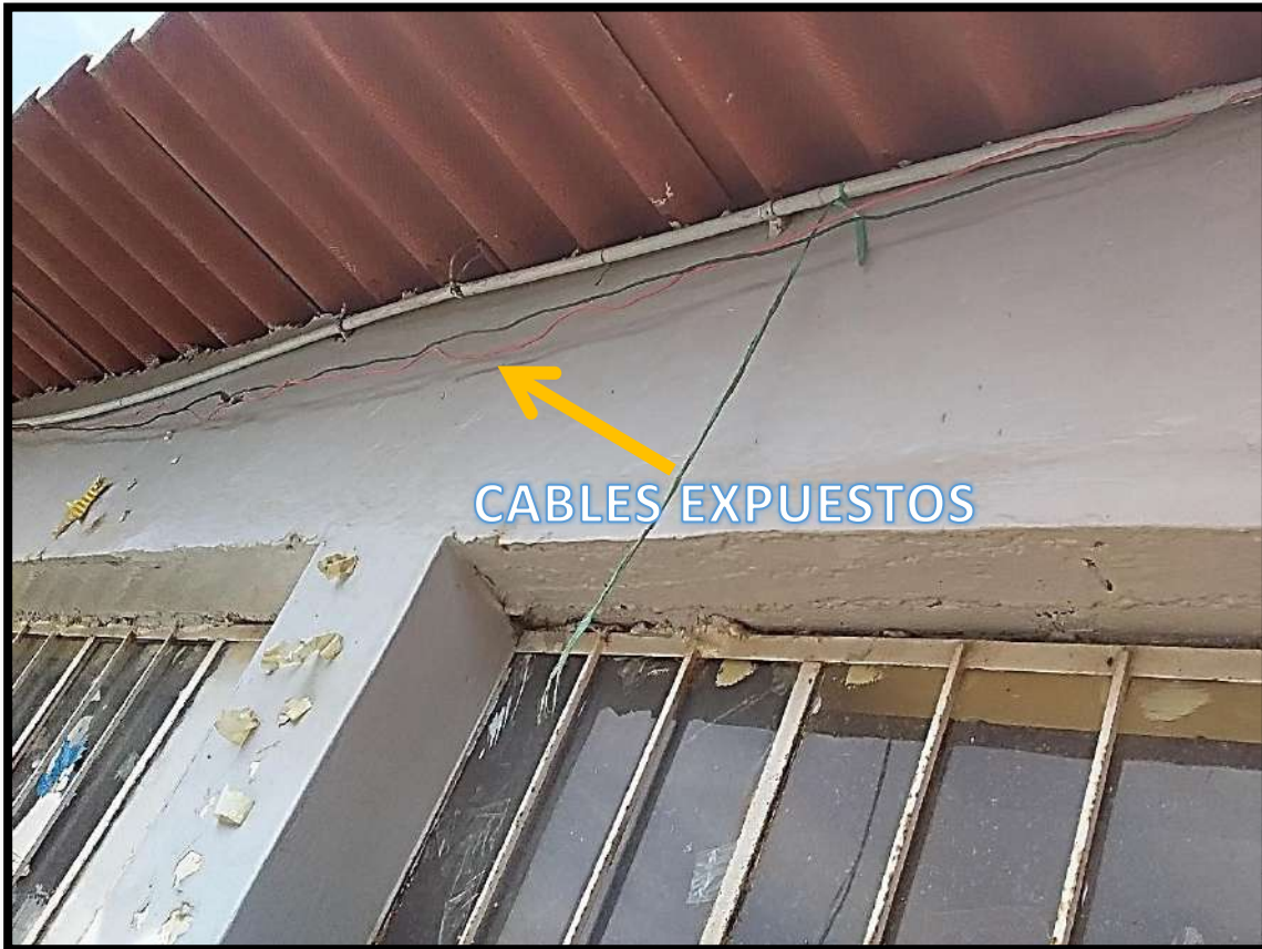
Foto N° 21. Las instalaciones eléctricas se encuentran expuestas y realizadas por mano de obra no calificada.
