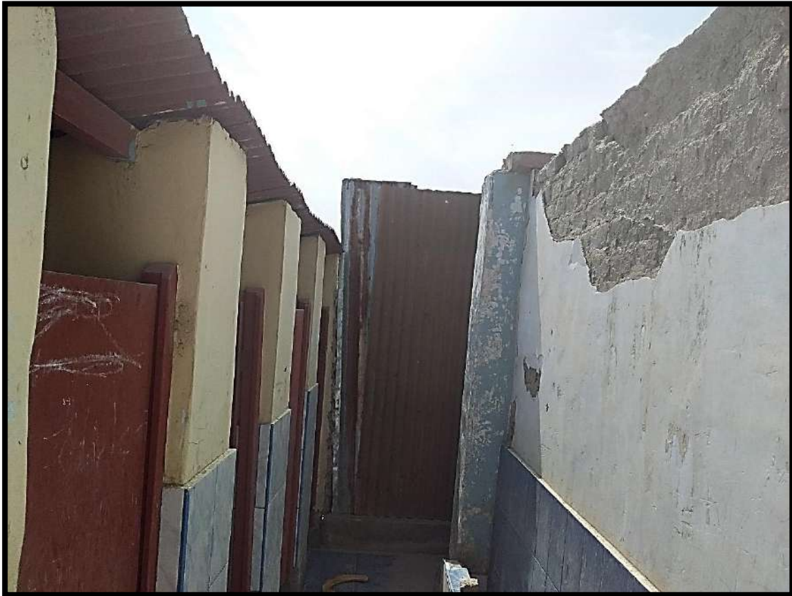
Foto N° 27. Baño de niños. No cumple con los niveles mínimos de confort Ambiental, pudiendo perjudicar su salud. Muro de adobe en peligro de colapso.
