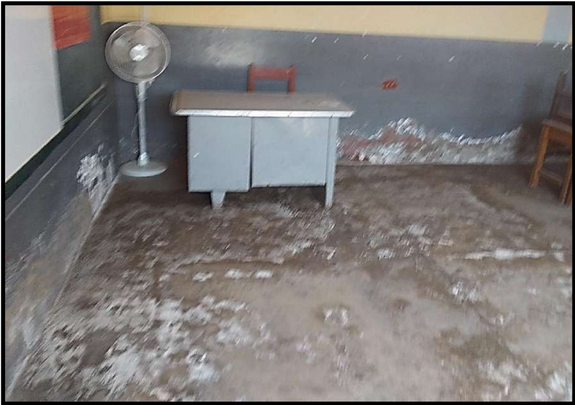
Foto N° 17. Se aprecia la humedad y el salitre en los pisos. Los ambientes No cumplen con los niveles mínimos de confort Ambiental para una saludable estancia, pudiendo perjudicar la salud de los niños.
