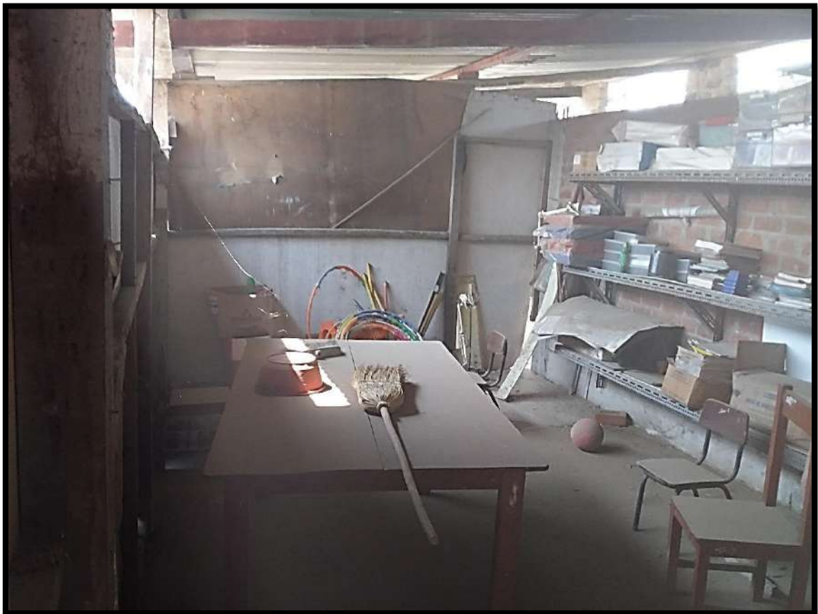
Foto N° 24. Almacén de material didáctico, en estado precario.
