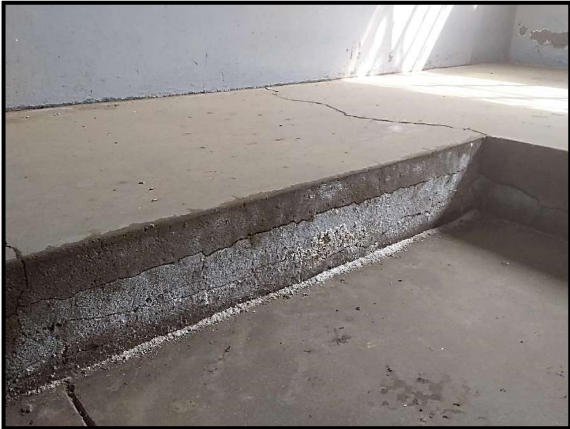
Foto N° 19. Afloramiento del salitre y grietas en los pisos.
