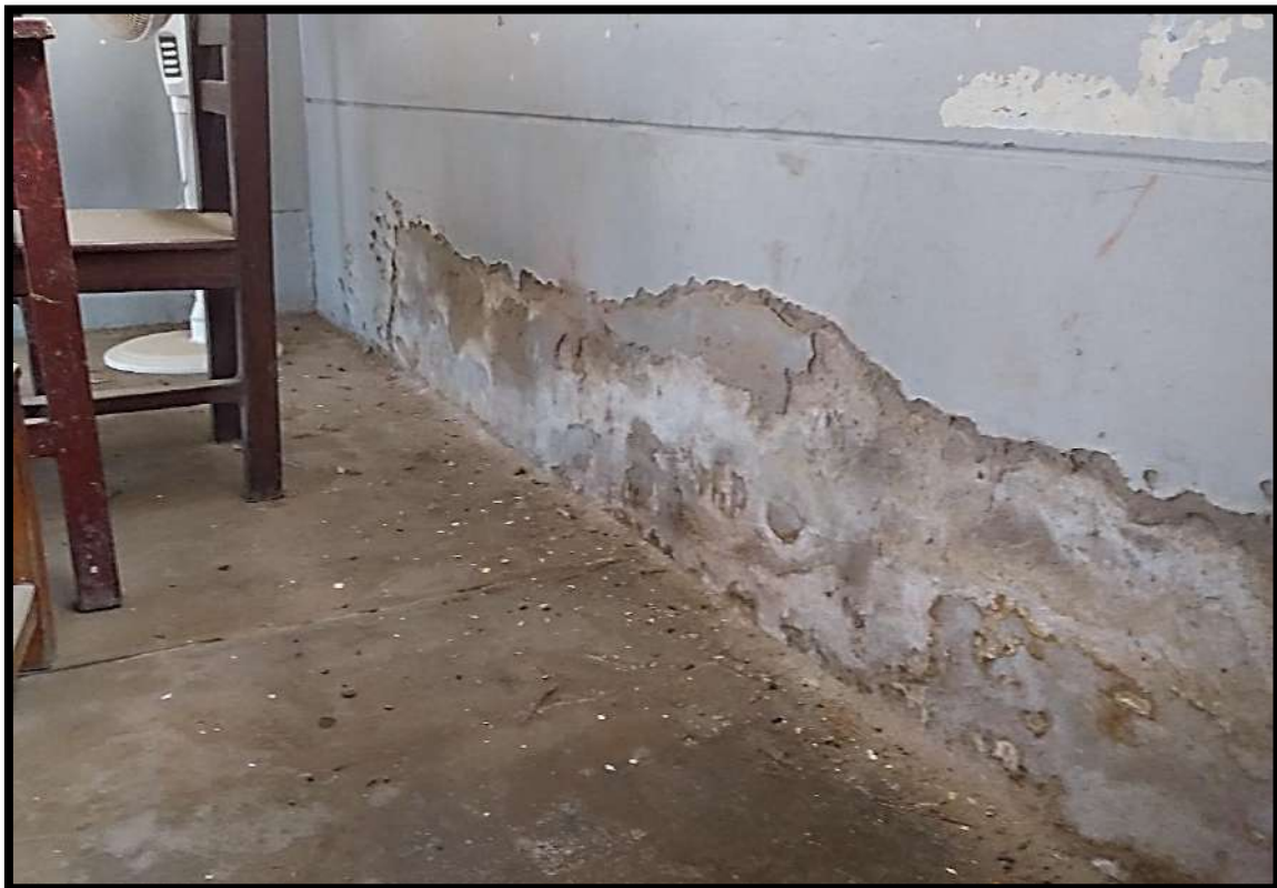
Foto N° 16. Muros corroídos por la humedad y el salitre.
