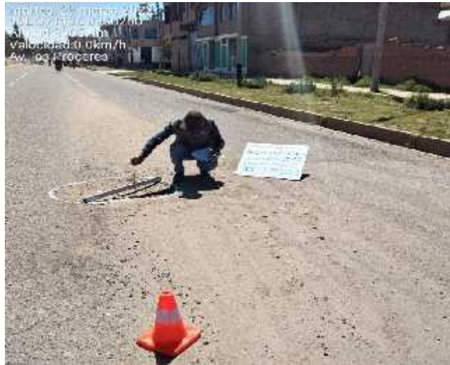
Figura 32 Medición de la falla identificada (unidad de muestra UM-04 0+060-0+080 margen derecha)
