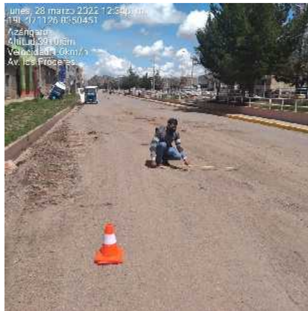
Figura 18 Evaluación de falla del pavimento flexible Av. Los Proceres.
