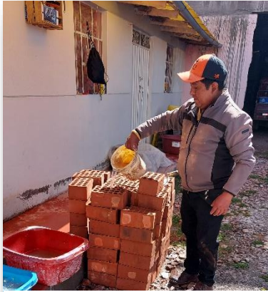
Figura 28.- realizando el mojado de los ladrillos previo a la elaboración de pilas y muretes
