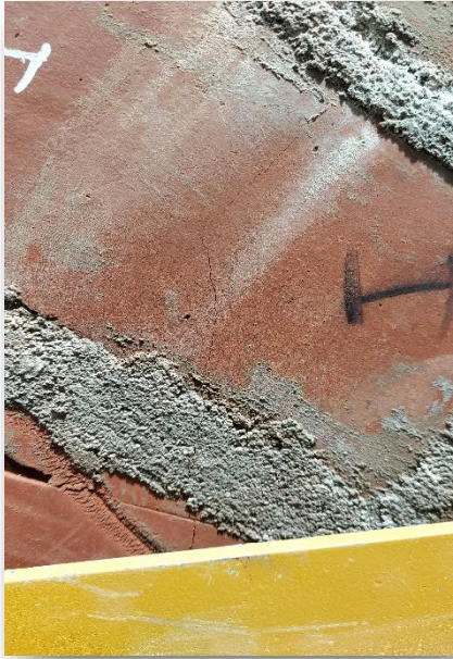
Figura 43.- falla de murete por compresión diagonal con dosificación 1
