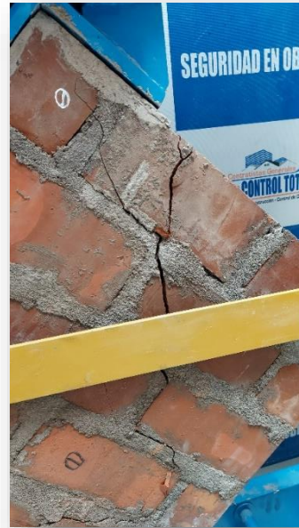
Figura 44.- falla diagonal en murete de albañilería
