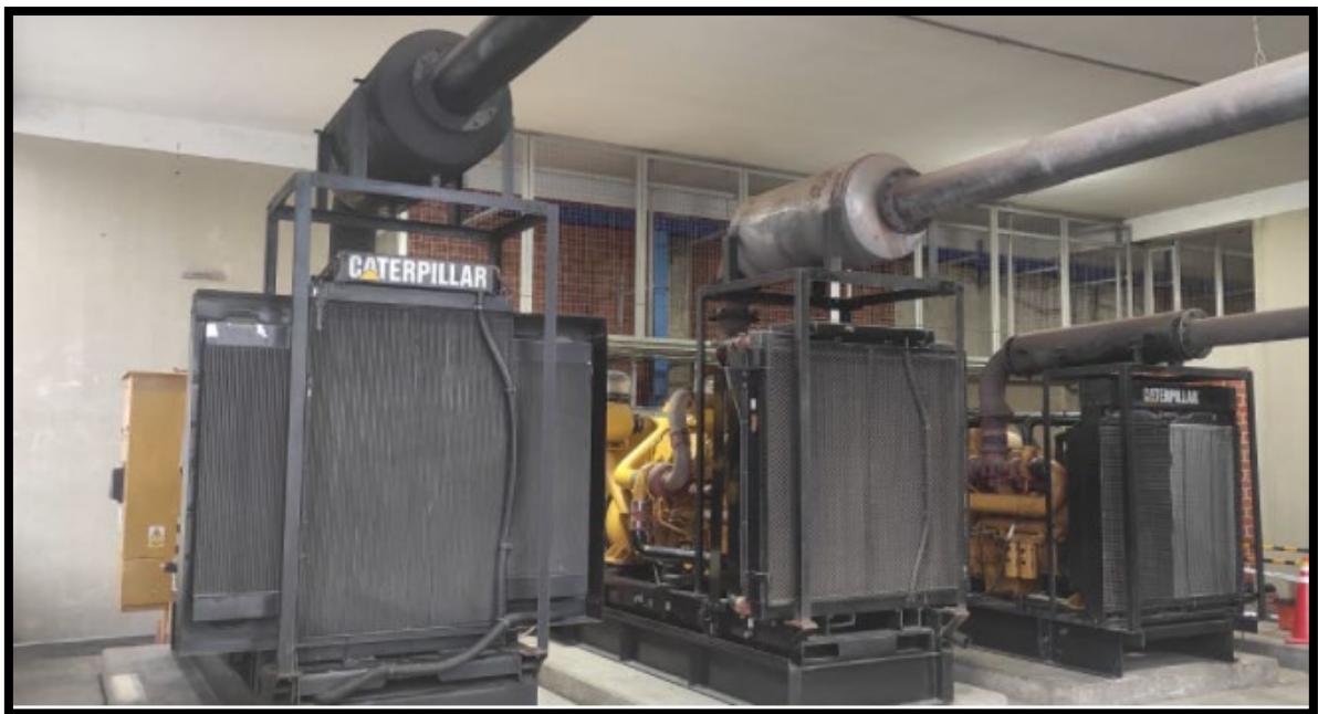
Figura 4: Vista interior de la sala de grupos electrógenos C32, C27 y C18.
