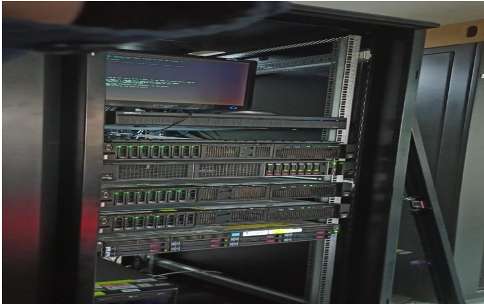
Figura 1. Estación de trabajo del centro de datos
